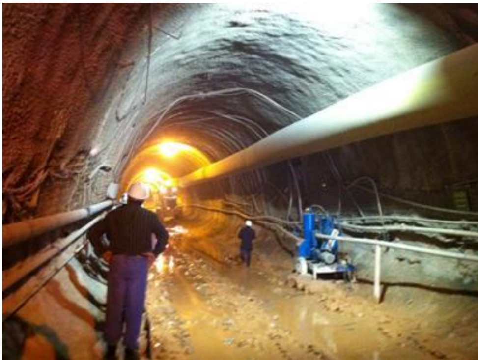
Foto 02: Túnel 2: a nascente no local ainda dificulta as obras e encareceu sua execução
