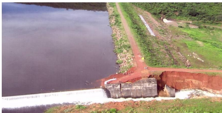
Foto 7 – Barragem Algodões I, observando-se o rompimento do aterro junto à ombreira esquerda.
