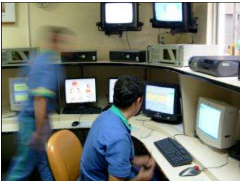
Central de controle industrial da SAMA
