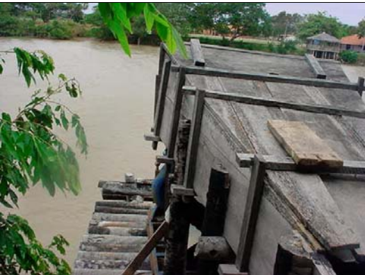
Precário estado da casa de bombas.
