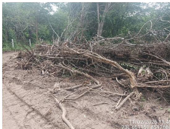
Figura 6 – Limpeza e remoção de vegetação sem adoção dos procedimentos previstos do PBA, Lote 6F. Coordenadas em Datum SIRGAS 2000.
