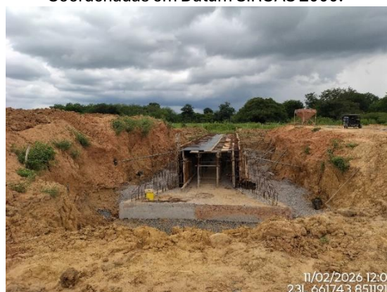
Figura 21 - Execução de obra de arte, km 801+420, Lote 6F-C, Coordenadas em Datum SIRGAS 2000.
