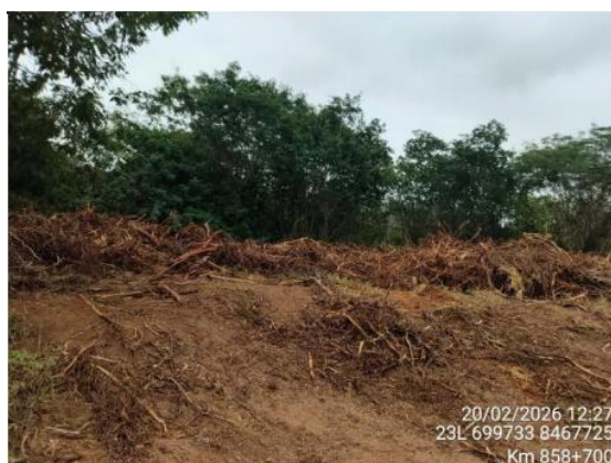
Figura 3 – Deposição inadequada de expurgo, km 658+700, Coordenadas em Datum SIRGAS 2000.
