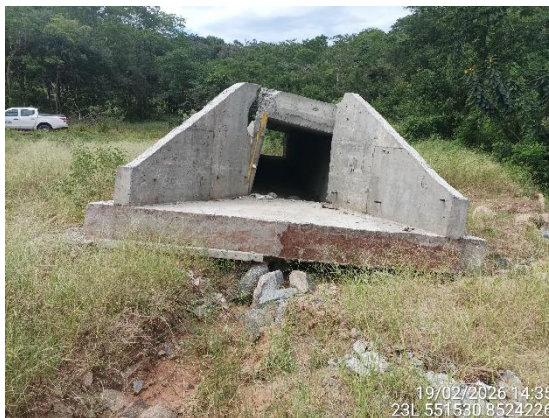
Figura 7 – Bueiro danificado, km 672+980, Lote 6F, Coordenadas em Datum SIRGAS 2000.
