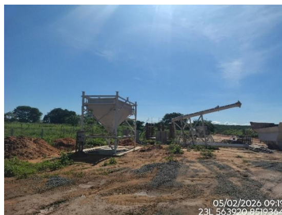
Figura 9 - Execução de nova central de concreto, km 689+000, Lote 6F-A, Coordenadas em Datum SIRGAS 2000.
