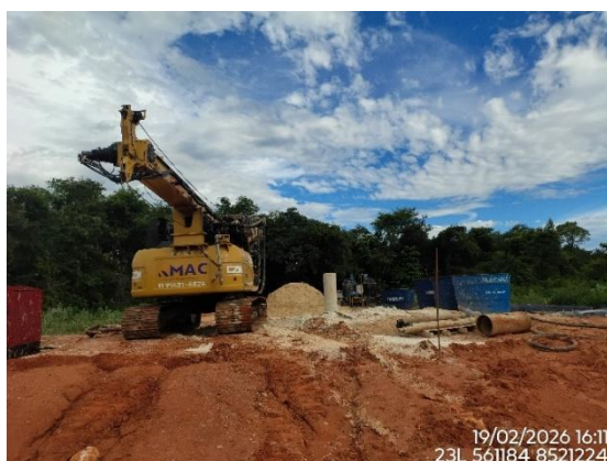
Figura 14 Execução de perfuração de estacas raiz para ponte, km 684+120, Lote 6F-A, Coordenadas em Datum SIRGAS 2000.
