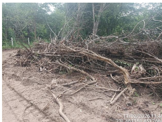
Figura 6 – Limpeza e remoção de vegetação sem adoção dos procedimentos previstos do PBA, Lote 6F. Coordenadas em Datum SIRGAS 2000.
