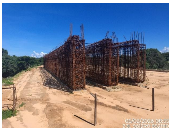
Figura 8 - Execução de estrutura metálica para ponte, km 684+320, Lote 6F-A, Coordenadas em Datum SIRGAS 2000.
