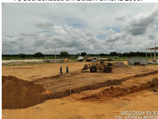
Figura 20 - Construção do canteiro de obras do lote 06F-C, km 796+400, Lote 6F-A, Coordenadas em Datum SIRGAS 2000.
