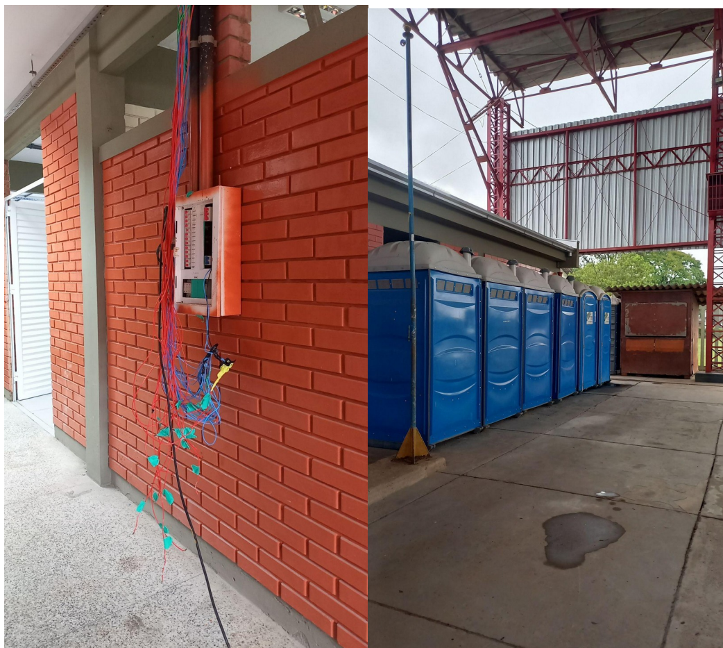
Figura 08 e 09: Instalações elétricas expostas e banheiros químicos para uso dos estudantes.
