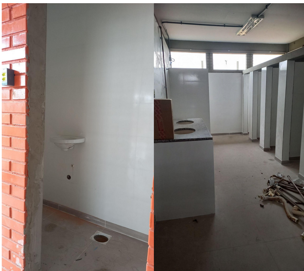
Figura 18, 19 e 20: Instalações sanitárias inacabadas.
