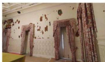
Visão das paredes com repinturas
