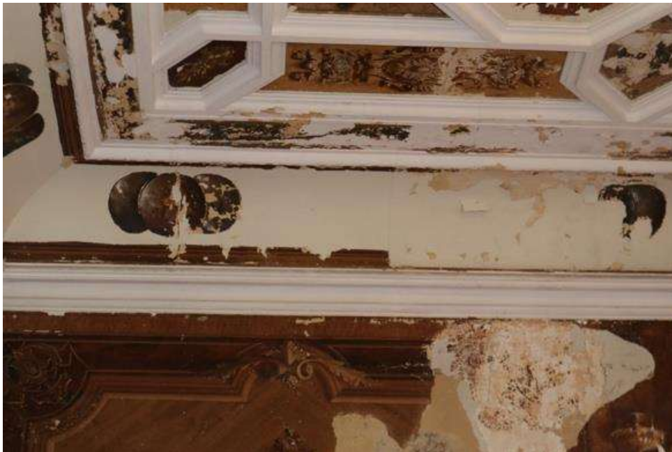
FIG.56 - Detalhes: danos na cimalha - grandes perdas de figura e simbologia
