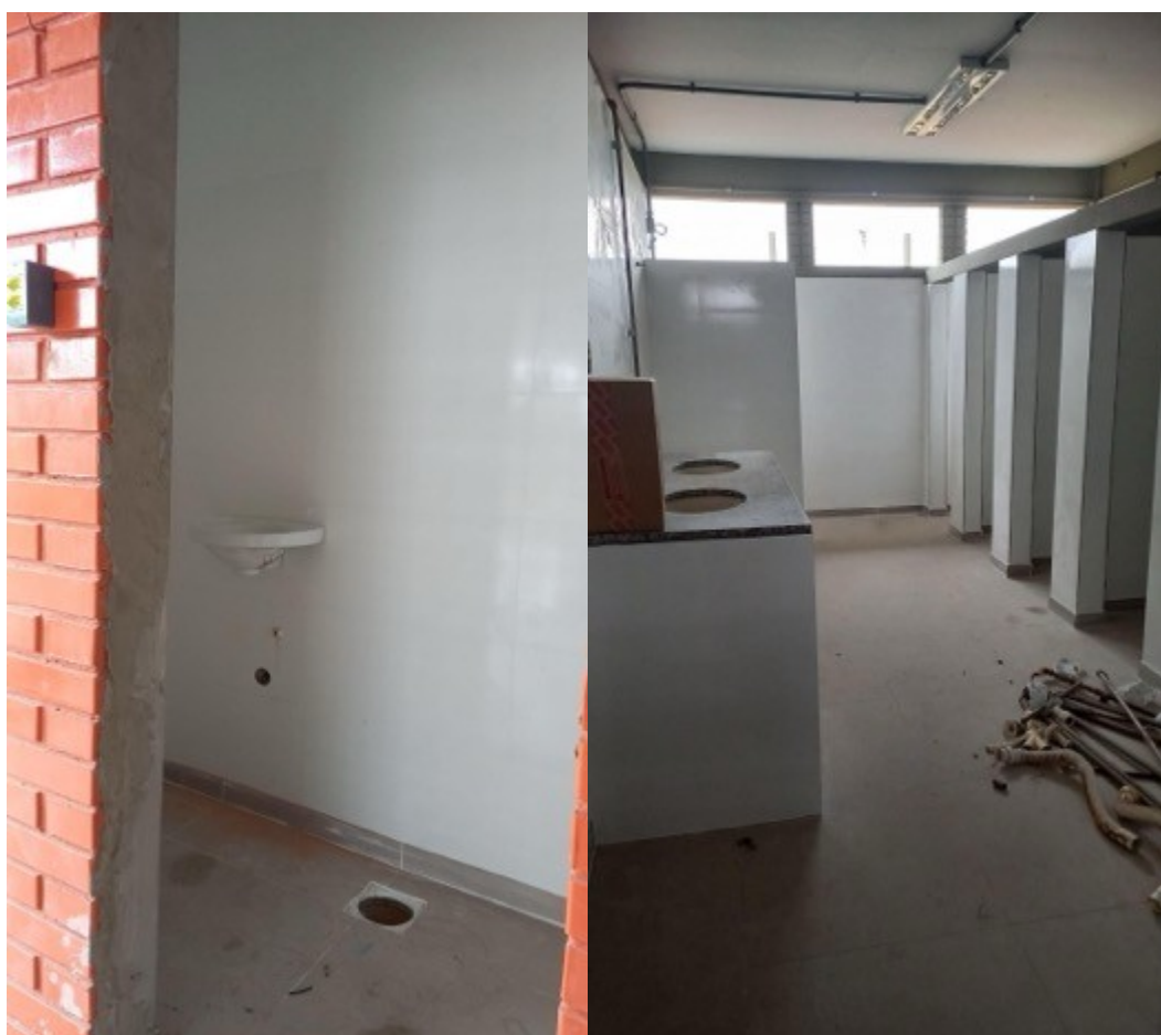
Figura 18, 19 e 20: Instalações sanitárias inacabadas.
