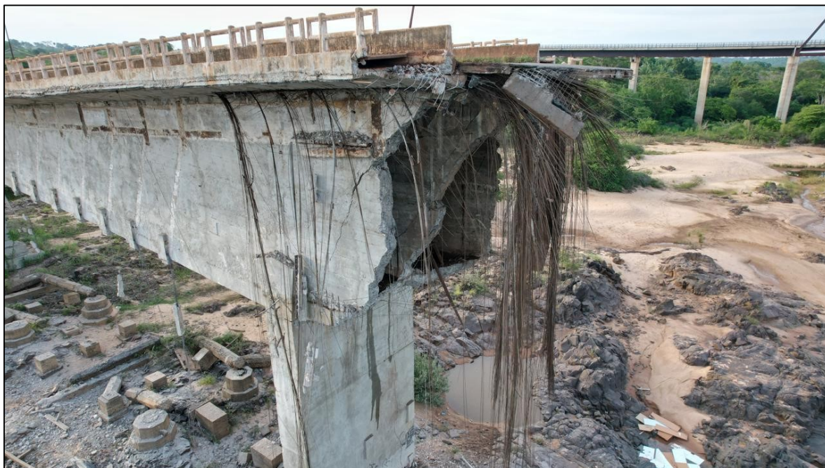
FOTO 01 – VÃO CENTRAL COLAPSO TOTAL DA ESTRUTURA
