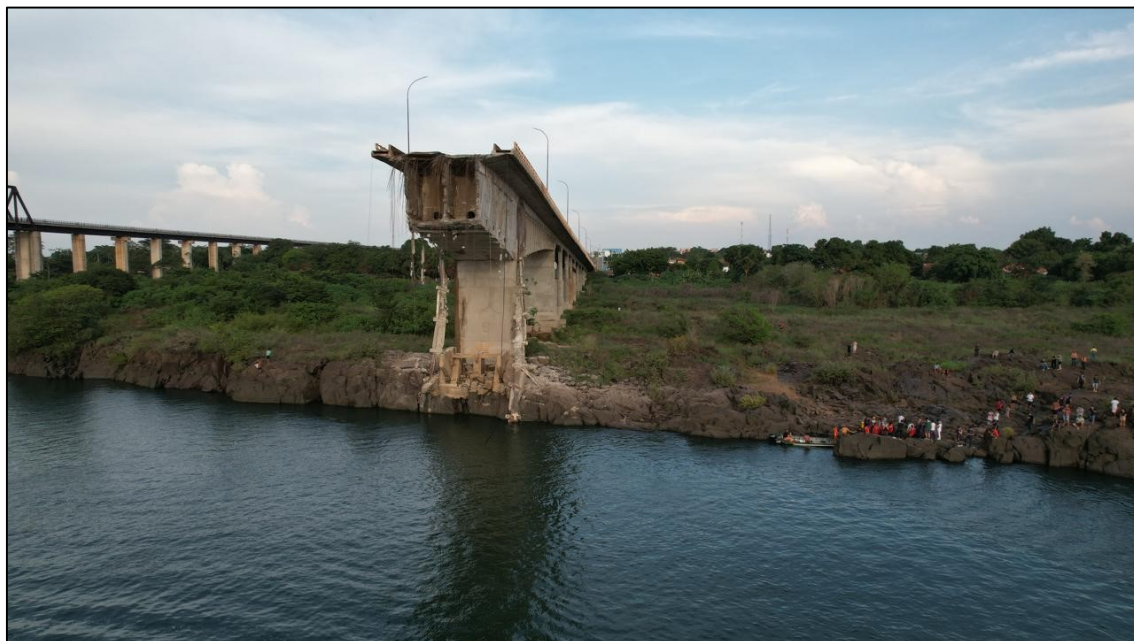
FOTO 05 – VÃO CENTRAL COLAPSO TOTAL DA ESTRUTURA
