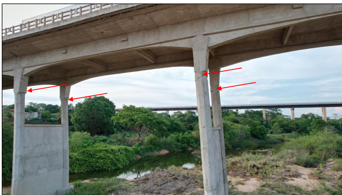
FOTO 06 – PILARES DANIFICADOS APÓS COLAPSO DA ESTRUTURA
