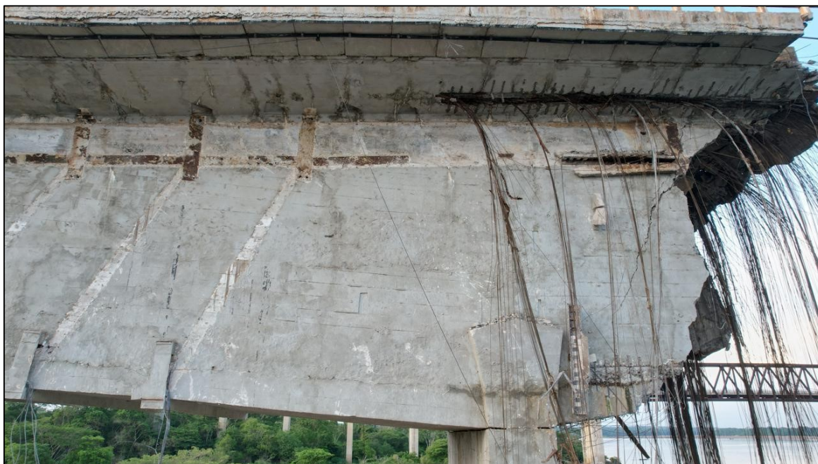
FOTO 04 – VÃO CENTRAL COLAPSO TOTAL DA ESTRUTURA
