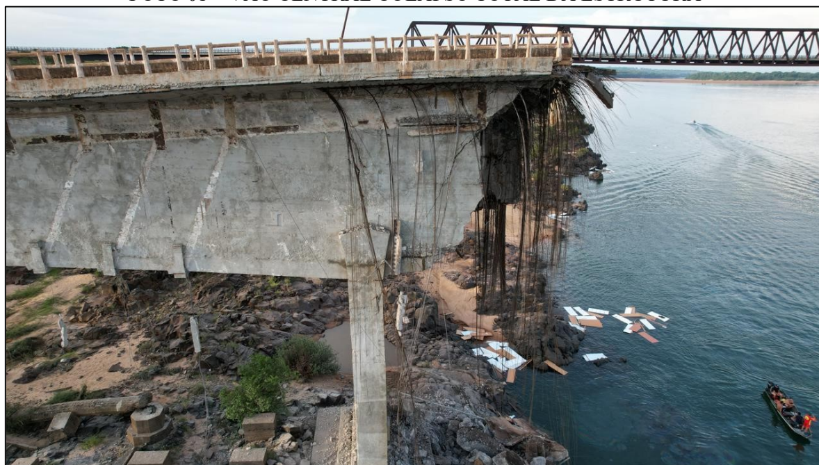
FOTO 02 – VÃO CENTRAL COLAPSO TOTAL DA ESTRUTURA
