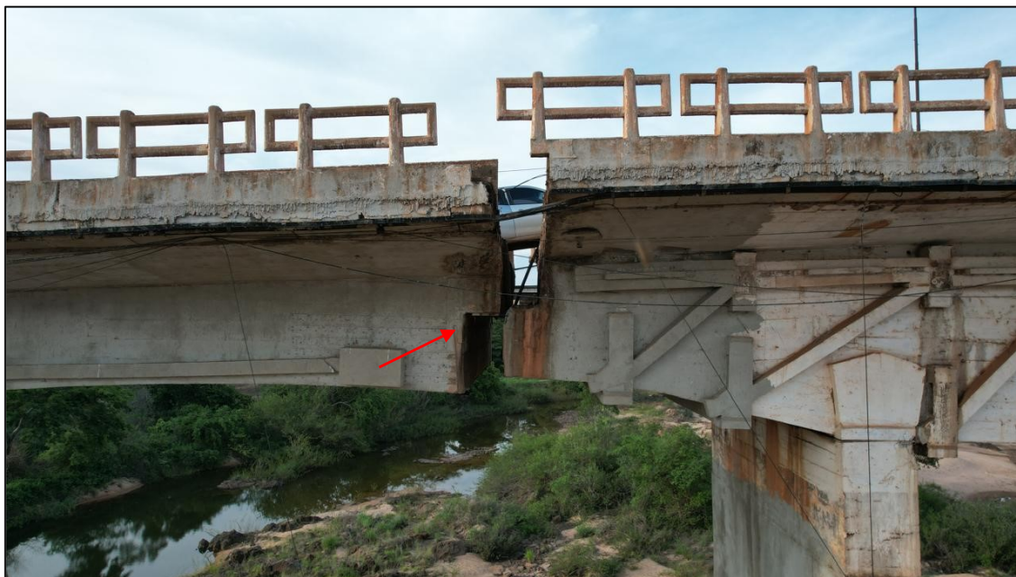
FOTO 07 – APOIOS DANIFICADOS APÓS COLAPSO DA ESTRUTURA
