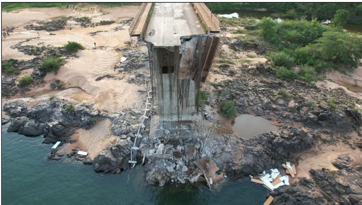
FOTO 03 – VÃO CENTRAL COLAPSO TOTAL DA ESTRUTURA
