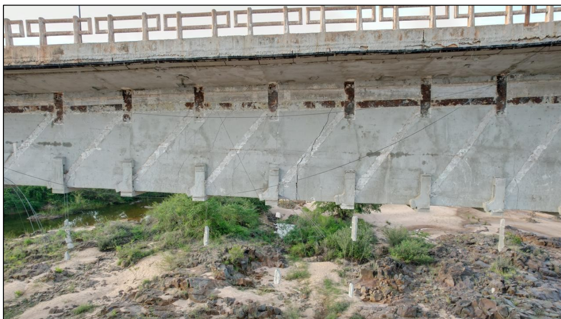
FOTO 08 – ESTRUTURA DA PROTENSÃO TOTALMENTE ROMPIDA
