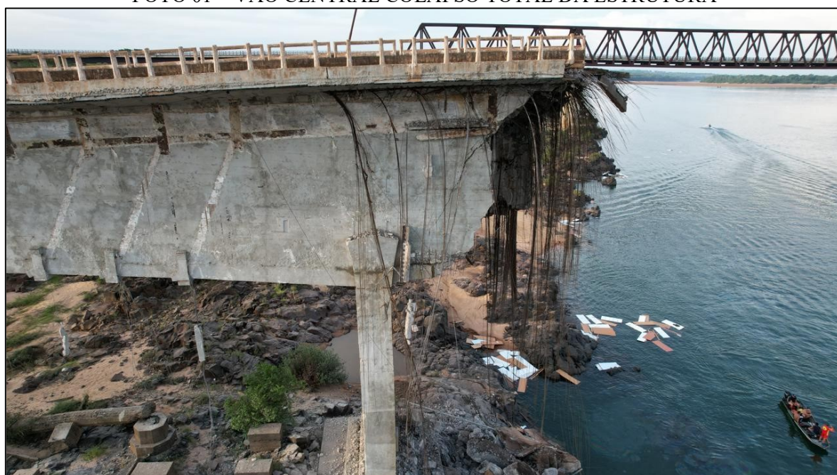
FOTO 02 – VÃO CENTRAL COLAPSO TOTAL DA ESTRUTURA
