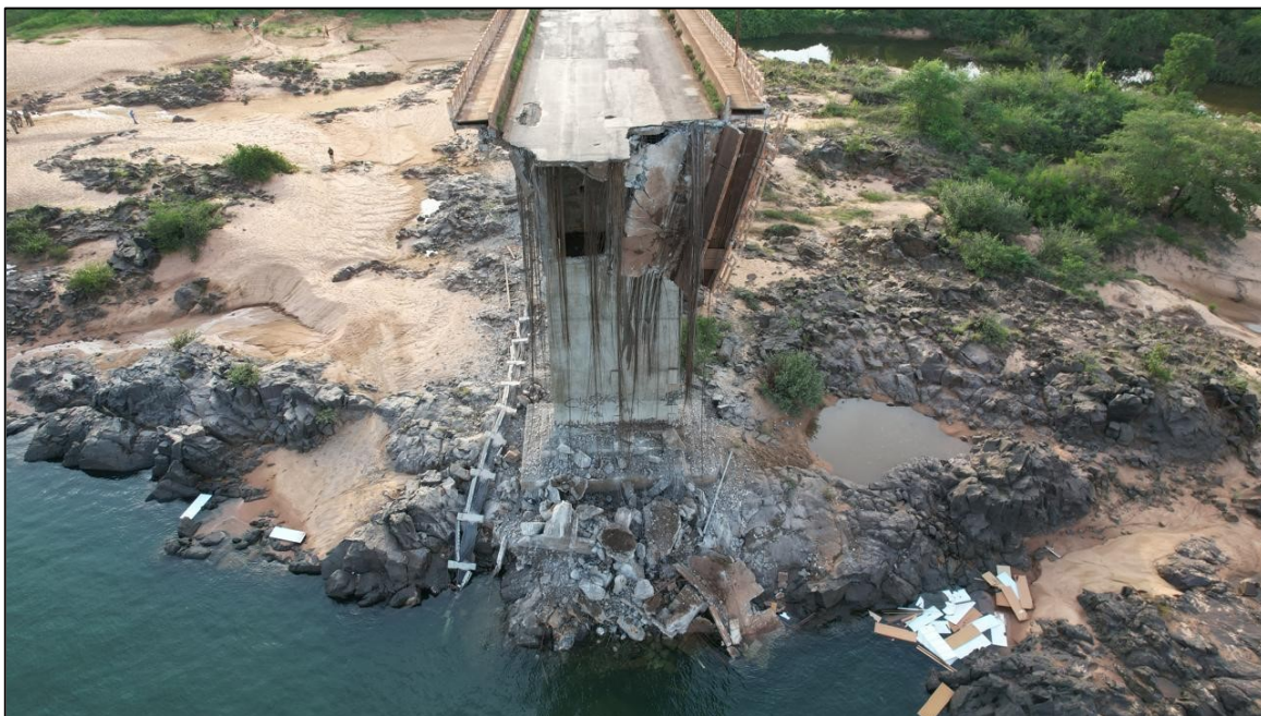
FOTO 03 – VÃO CENTRAL COLAPSO TOTAL DA ESTRUTURA
