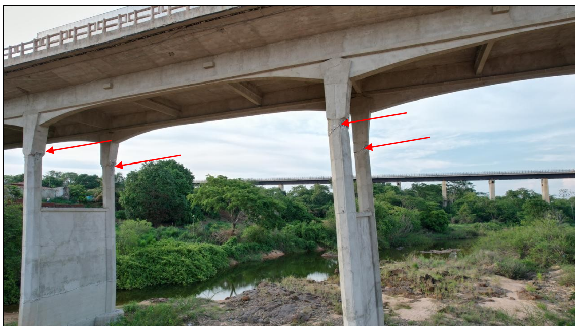
FOTO 06 – PILARES DANIFICADOS APÓS COLAPSO DA ESTRUTURA
