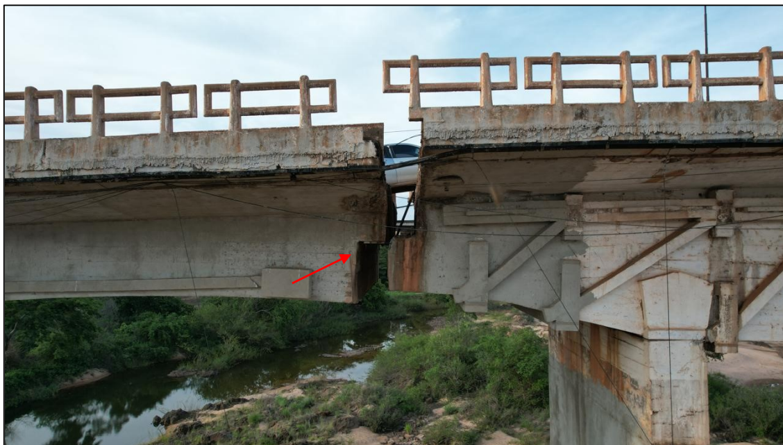
FOTO 07 – APOIOS DANIFICADOS APÓS COLAPSO DA ESTRUTURA
