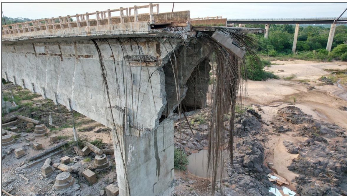
FOTO 01 – VÃO CENTRAL COLAPSO TOTAL DA ESTRUTURA
