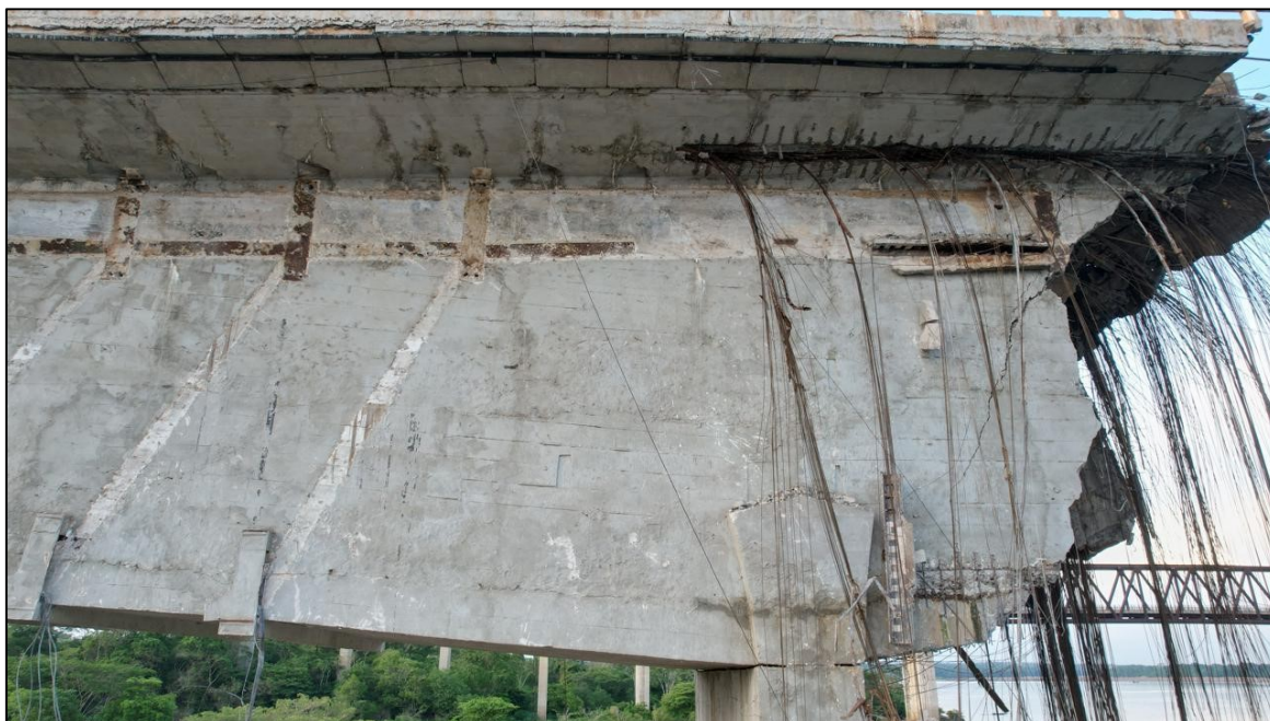
FOTO 04 – VÃO CENTRAL COLAPSO TOTAL DA ESTRUTURA
