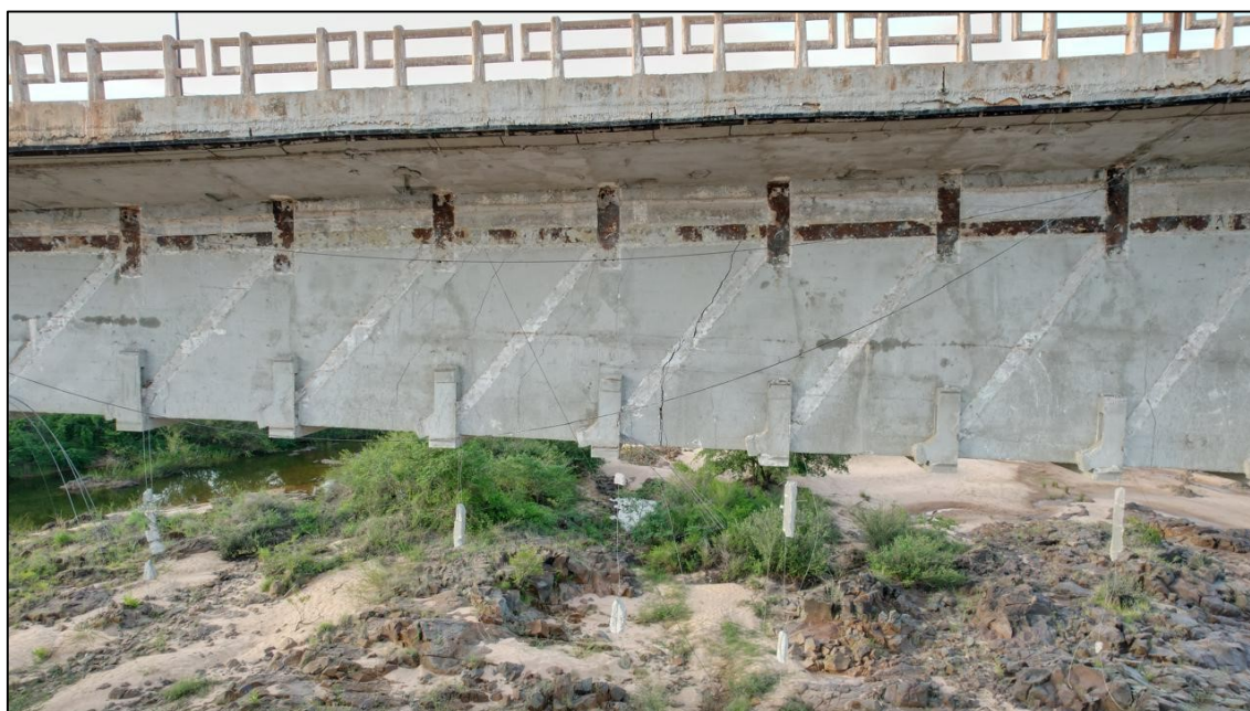
FOTO 08 – ESTRUTURA DA PROTENSÃO TOTALMENTE ROMPIDA
