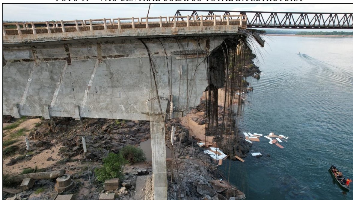
FOTO 02 – VÃO CENTRAL COLAPSO TOTAL DA ESTRUTURA
