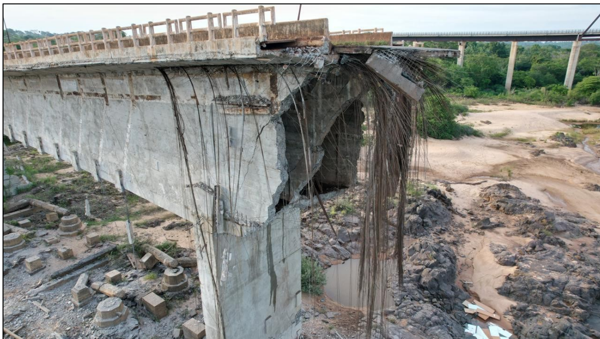
FOTO 01 – VÃO CENTRAL COLAPSO TOTAL DA ESTRUTURA
