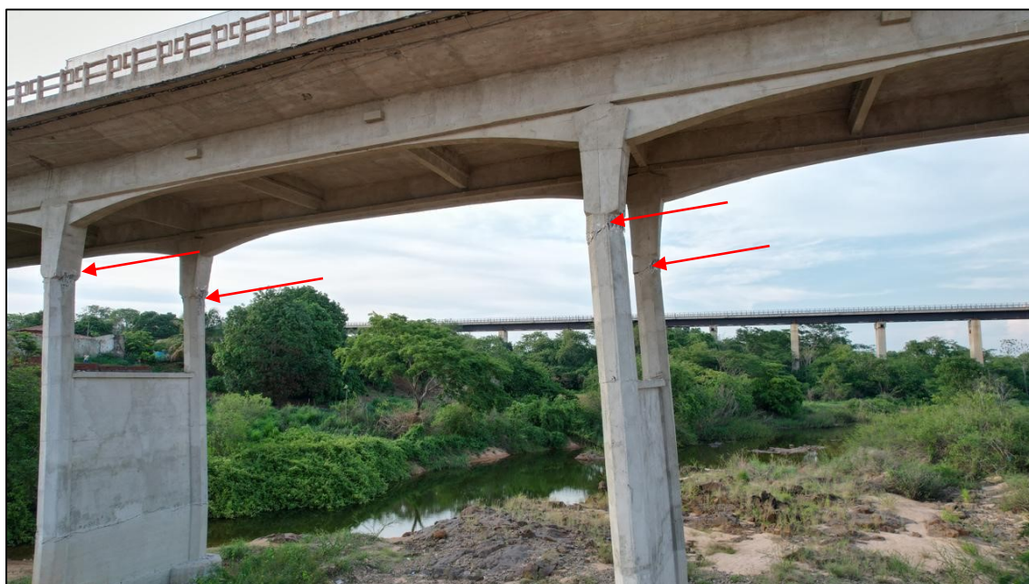
FOTO 06 – PILARES DANIFICADOS APÓS COLAPSO DA ESTRUTURA
