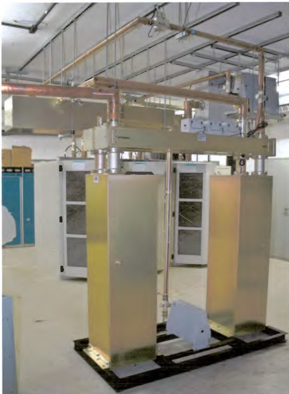
Foto 4 - Vista da Parte Traseira do Equipamento mostrando as interligações das diversas unidades, a Saída de R.F. e as cargas de rejeição.
