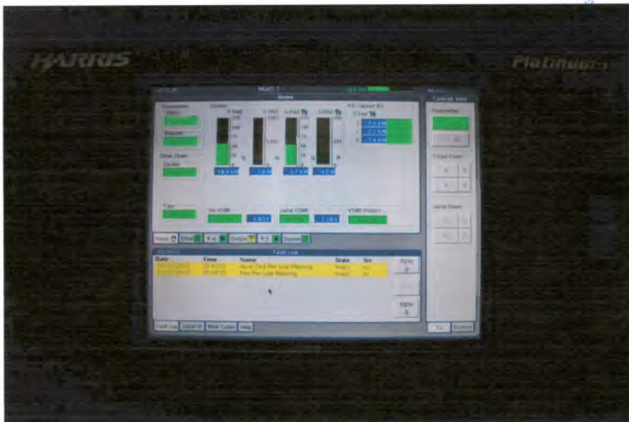
Foto 2 – Vista da Unidade de Monitoração e Controle de Combinação dos Amplificadores em Paralelo
