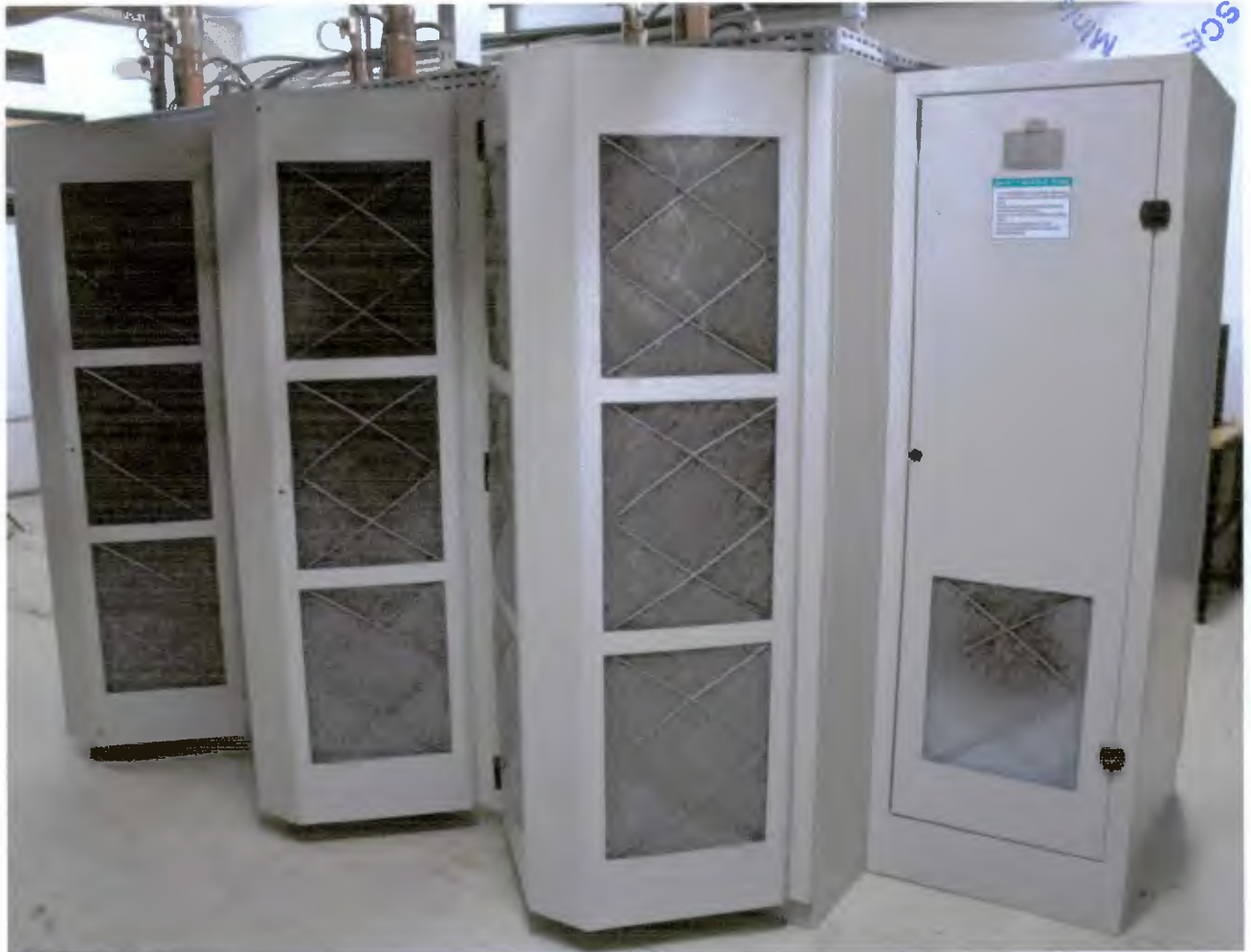
Foto 3 - Vista da Parte Traseira do Equipamento.
