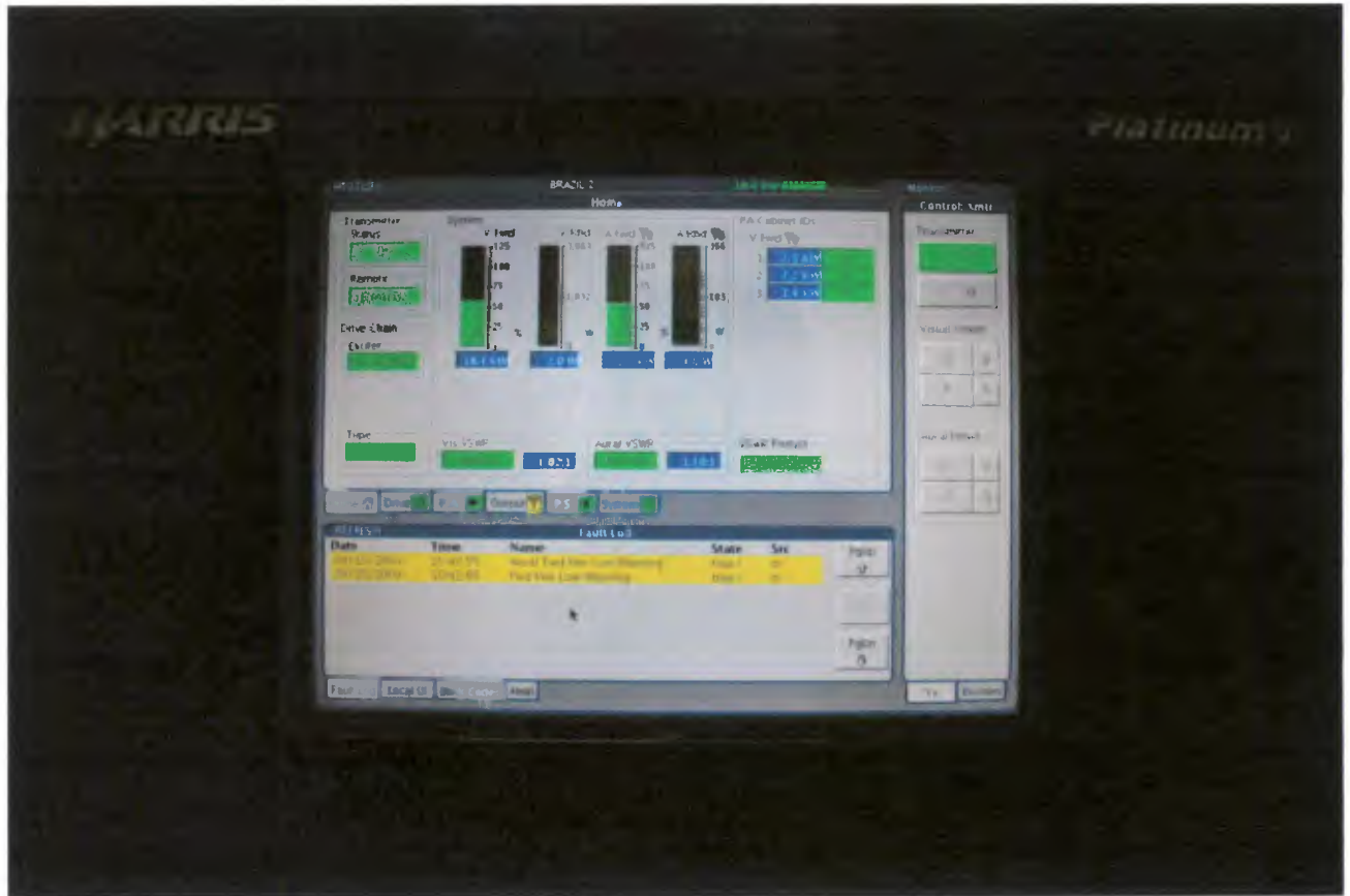
Foto 2 – Vista da Unidade de Monitoração e Controle de Combinação dos Amplificadores em Paralelo
