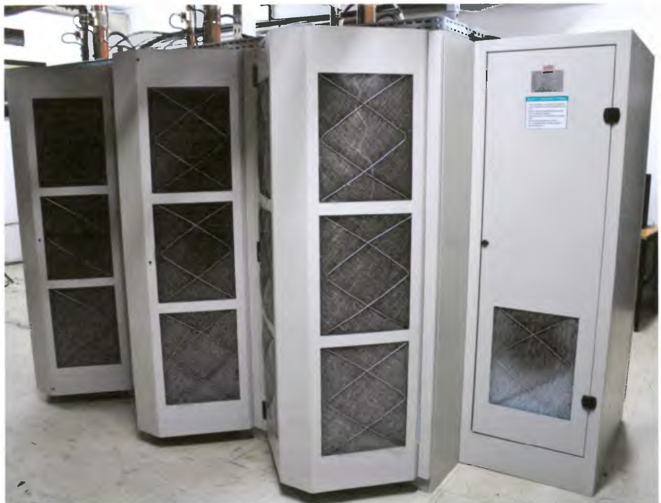
Foto 3 - Vista da Parte Traseira do Equipamento.
