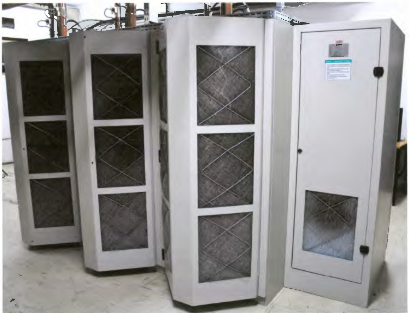
Foto 3 - Vista da Parte Traseira do Equipamento.
