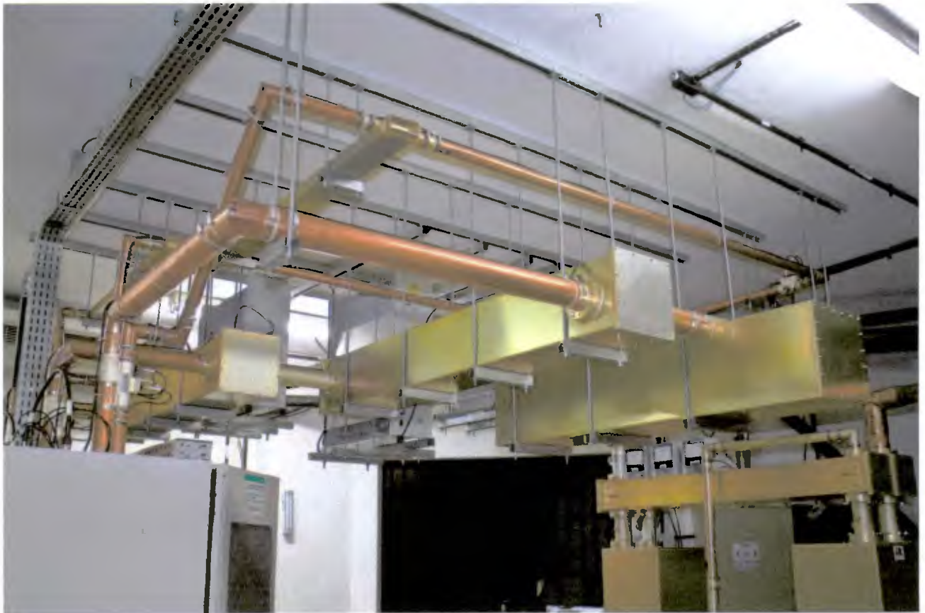
Foto 5 – Vista da Parte Superior do Transmissor, mostrando os combinadores de áudio e vídeo.
