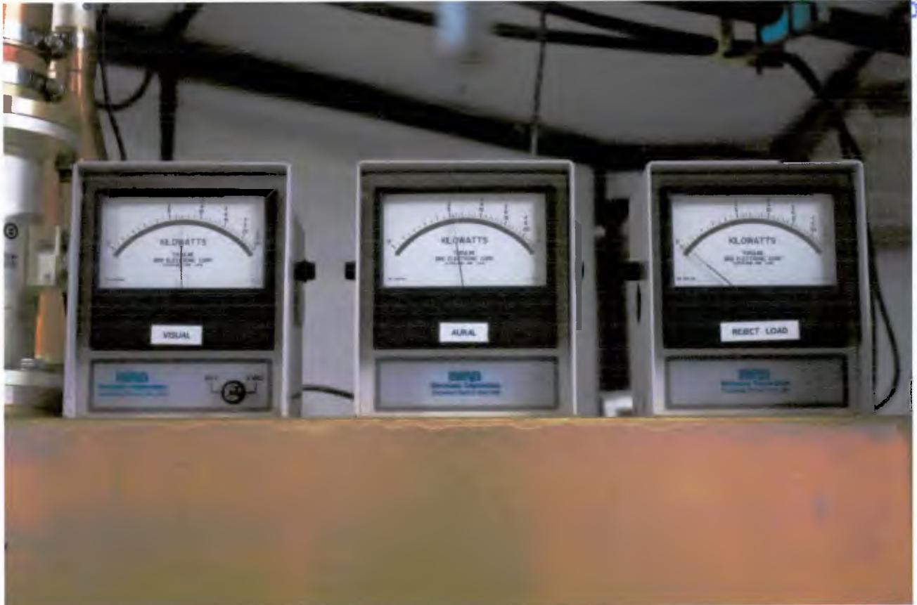
Foto 6 – Vista do Sistema de Medições do Sistema – Wattímetros Bird.
