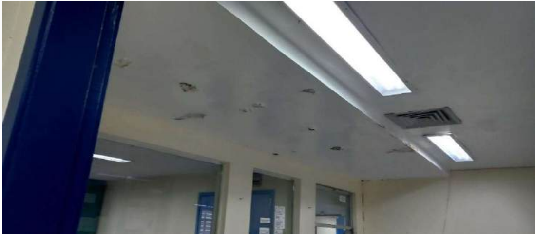
Fig. 8 – Sinais de infiltrações no teto.
