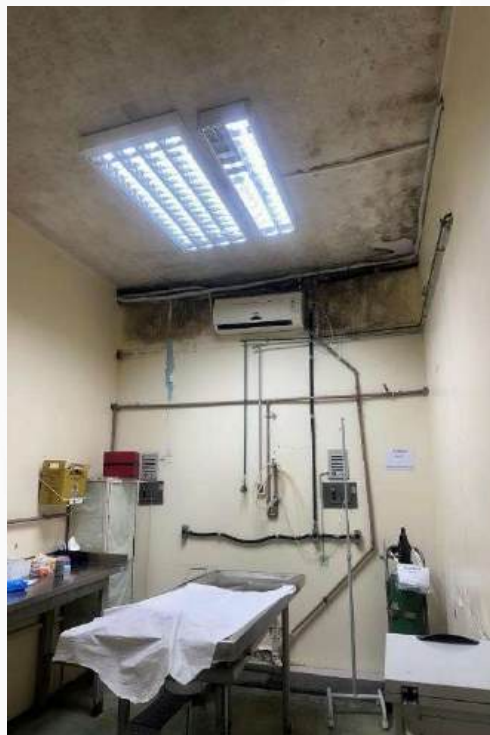
Fig. 21 – Paredes e teto com sinais de infiltração, manchas, mofo, bolor e alteração no revestimento de pintura.
