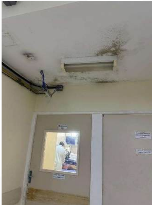
Fig. 14 – Teto com infiltração, manchas, mofo, bolor e circulação em frente à enfermaria 805.
