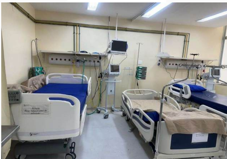
Fig. 13 – UPO - Leitos fechados, aguardando adequação da rede elétrica.
