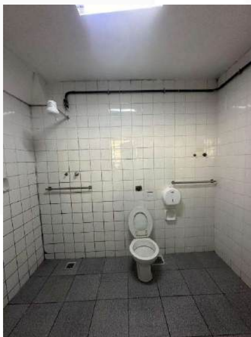
Fig. 17 – As enfermarias necessitam de adequação de espaço físico.
