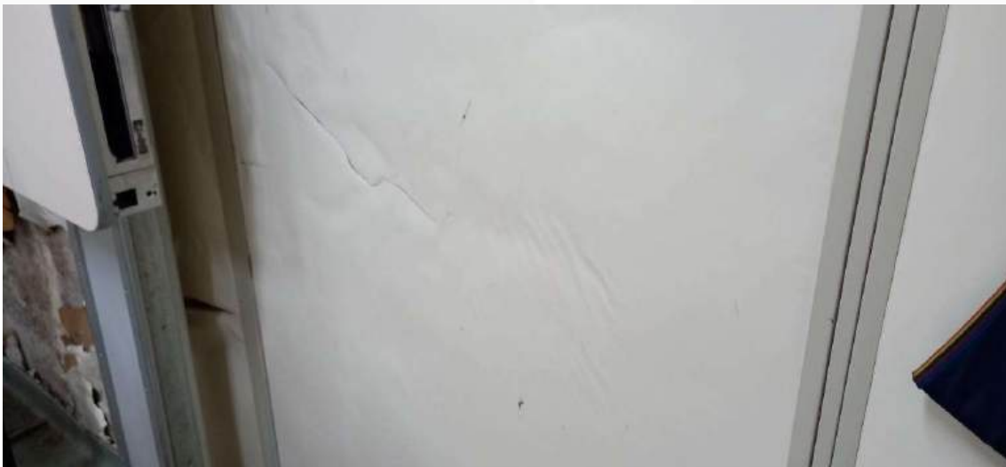
Fig. 24 e 25 – Problemas nas paredes do setor RX – 01, aguardando adequação.
