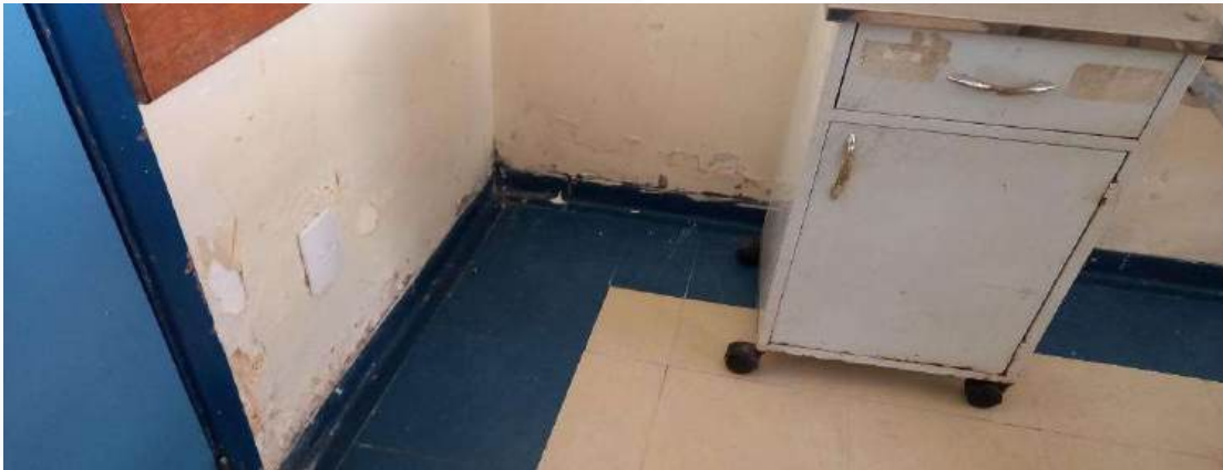
Fig.20 – Sinais de infiltrações na Enfermaria vindos do Banheiro.
