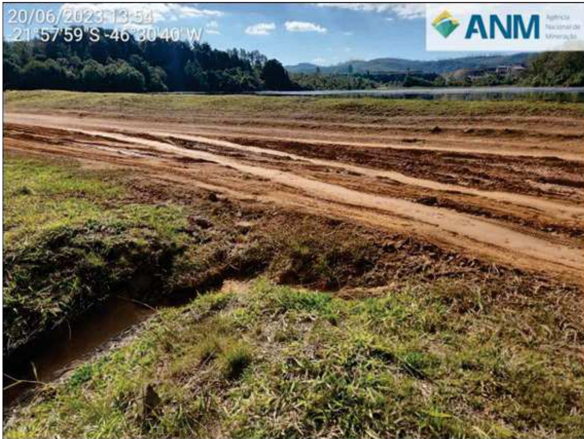
Figura 3.3 – Irregularidades e problemas de drenagem superficial da crista
