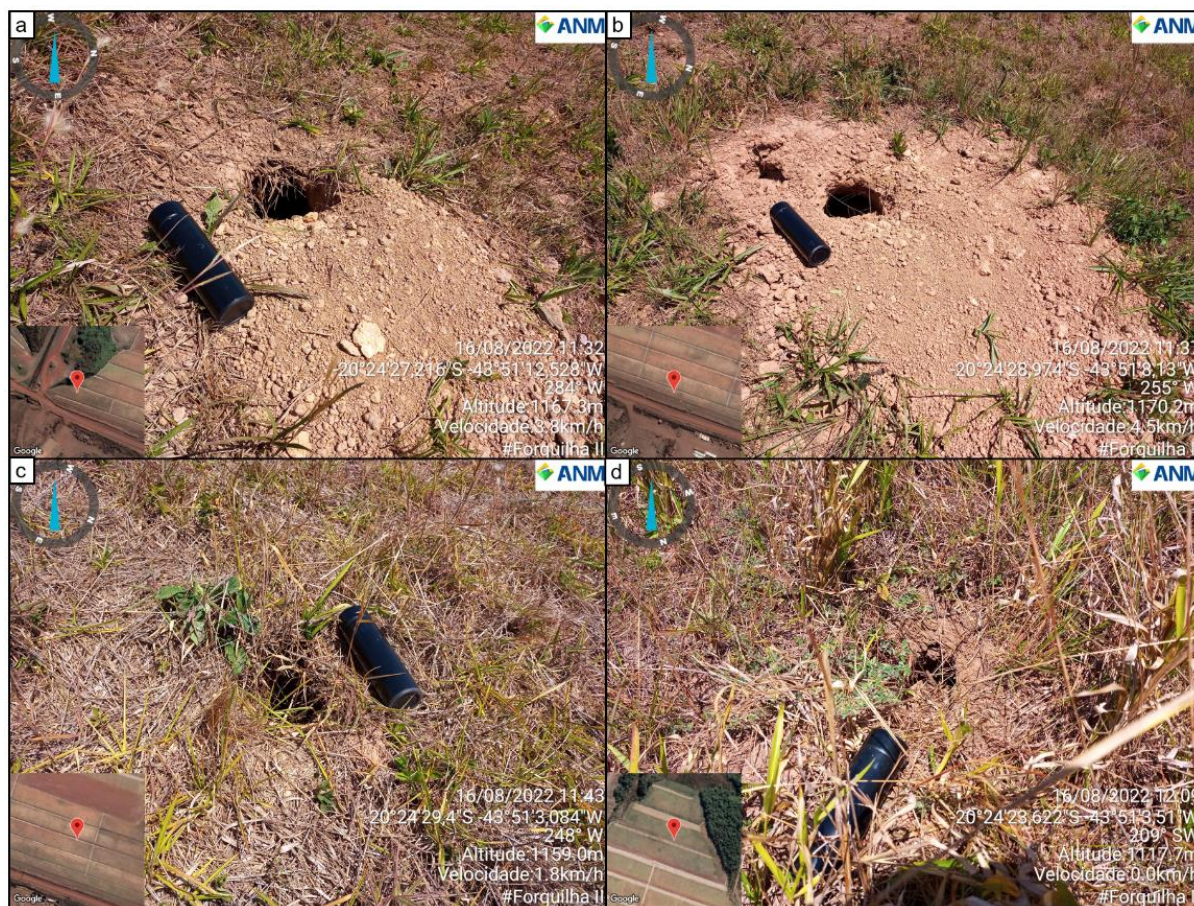
Figura 28. Buracos de pequenas dimensões em diferentes partes do maciço.
