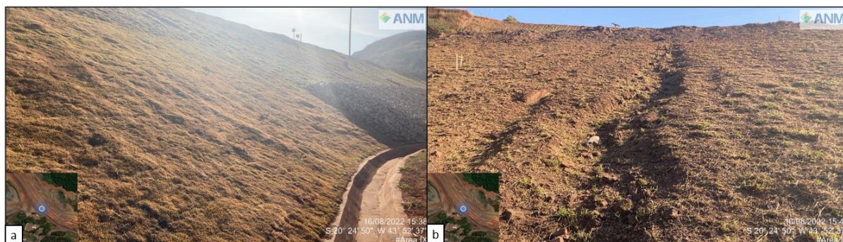
Figura 4- Talude de jusante (a)Região próxima a ombreira esquerda, finalização do dreno invertido (b) Irregularidade superficial nos taludes.
