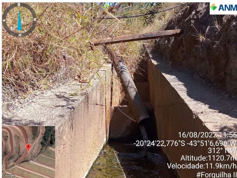
Figura 26- Saída de dreno interno identificado em escada hidráulica situada na ombreira esquerda
