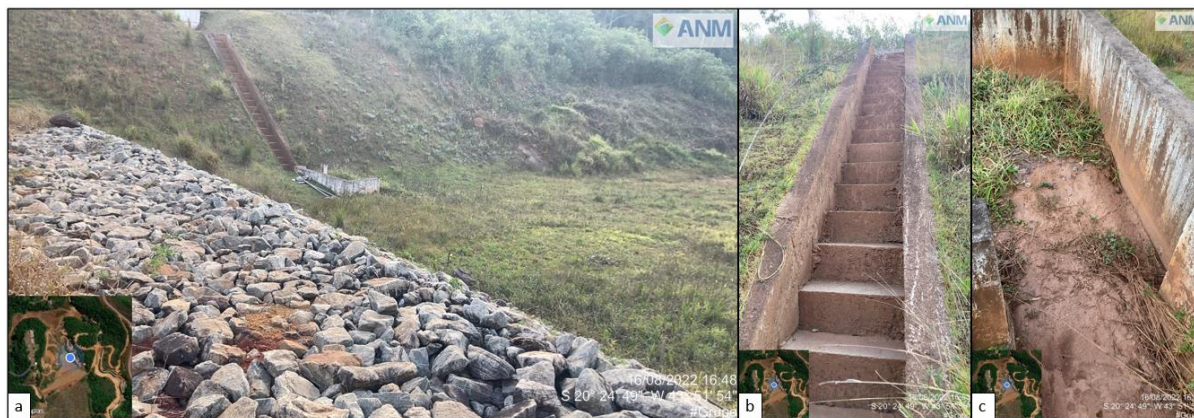
Figura 12- Canal de drenagem ombreira esquerda (a) vista da descida (b) descida (c) assoreamento no pé da escada.
