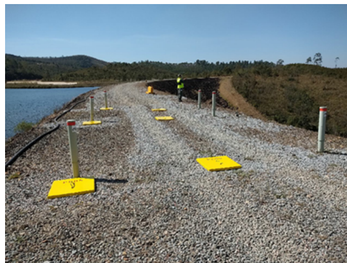
Foto 04: Crista da Barragem de Rejeitos recoberta com brita, inviabilizando a identificação de eventuais rachaduras por movimentação interna.
