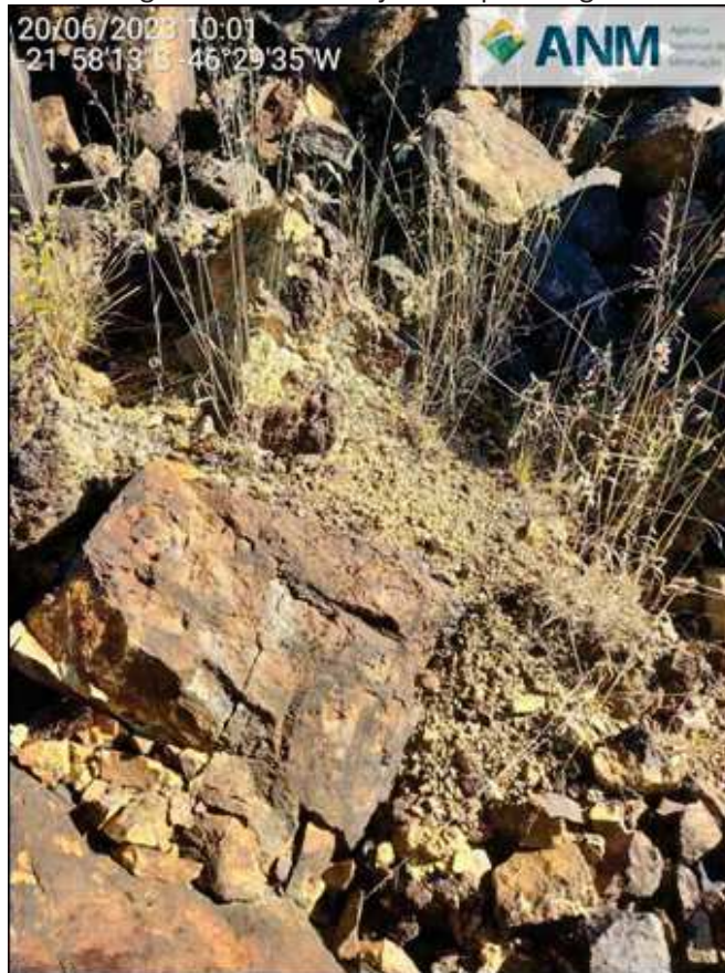
Figura 2.5 – Degradação do enrocamento no espaldar de jusante
