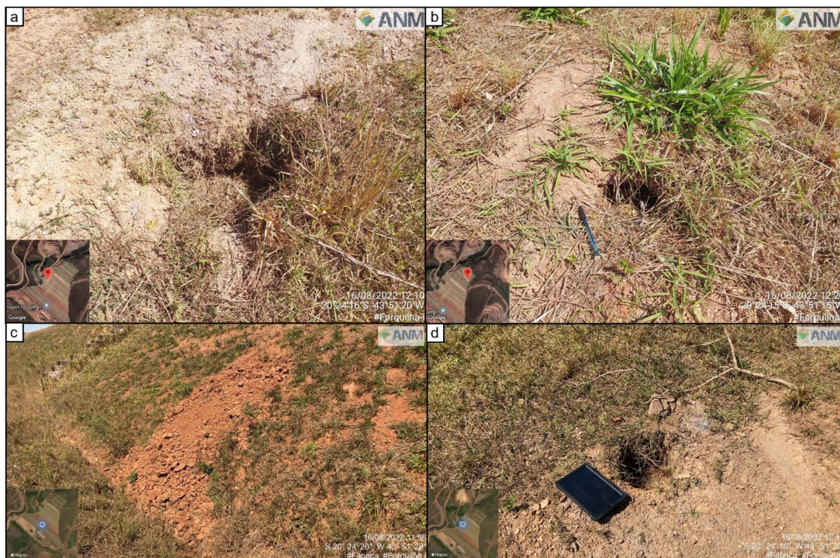
Figura 19. Buracos ou irregularidades na superfície dos taludes de jusante.
