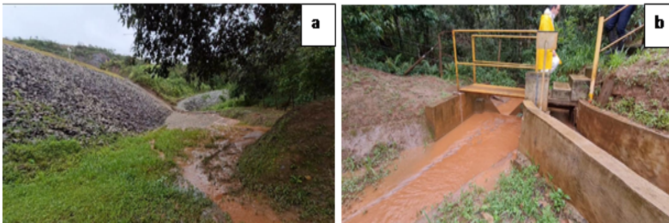
Figura 4. a) Canaleta obstruída desviando a água pluvial em direção ao dreno de pé; e b) medidor de vazão do dreno de pé do Dique de Sela, com incremento de vazão e turbidez da água pluvial desviada.
