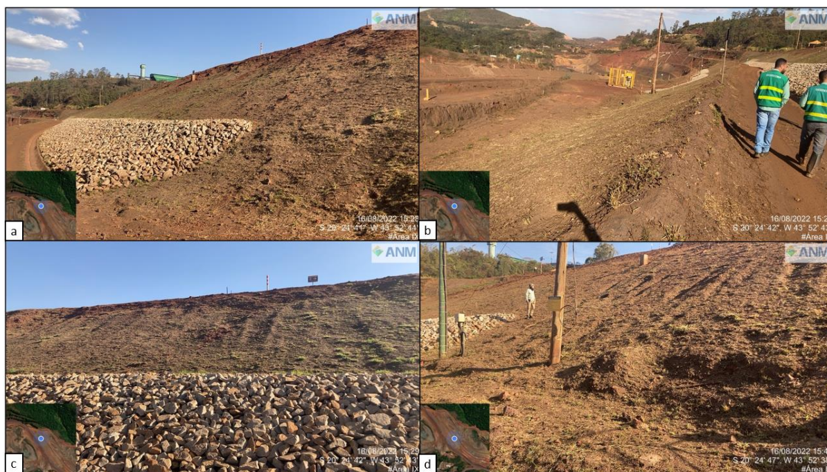
Figura 3-Talude de jusante (a)Região próxima a ombreira direita (b)Vista do talude inferior (c) Detalhe do dreno invertido (d)detalhe de irregularidades no talude de jusante próxima a região central.
