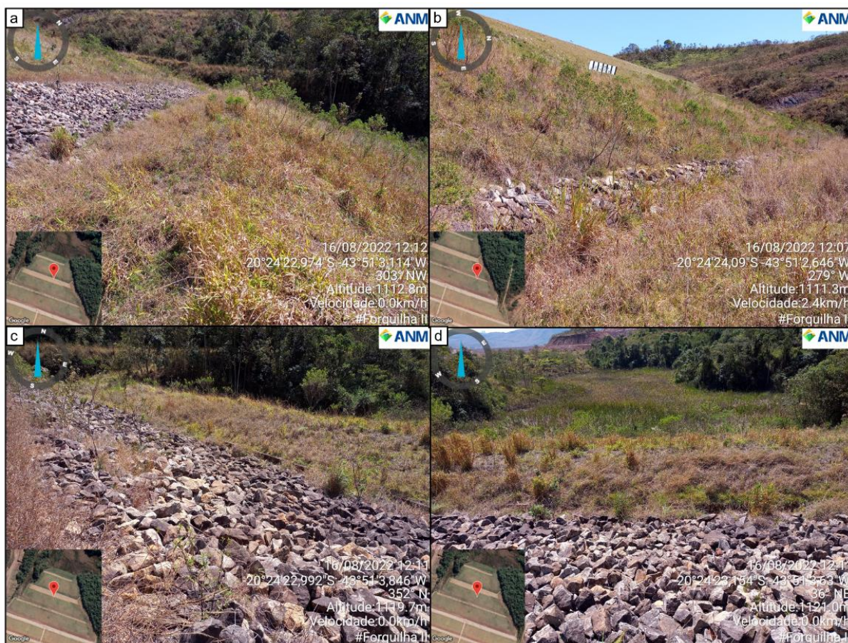
Figura 27. Taludes do pé da Forquilha II. Vegetação alta não permite identificar as condições do maciço.
