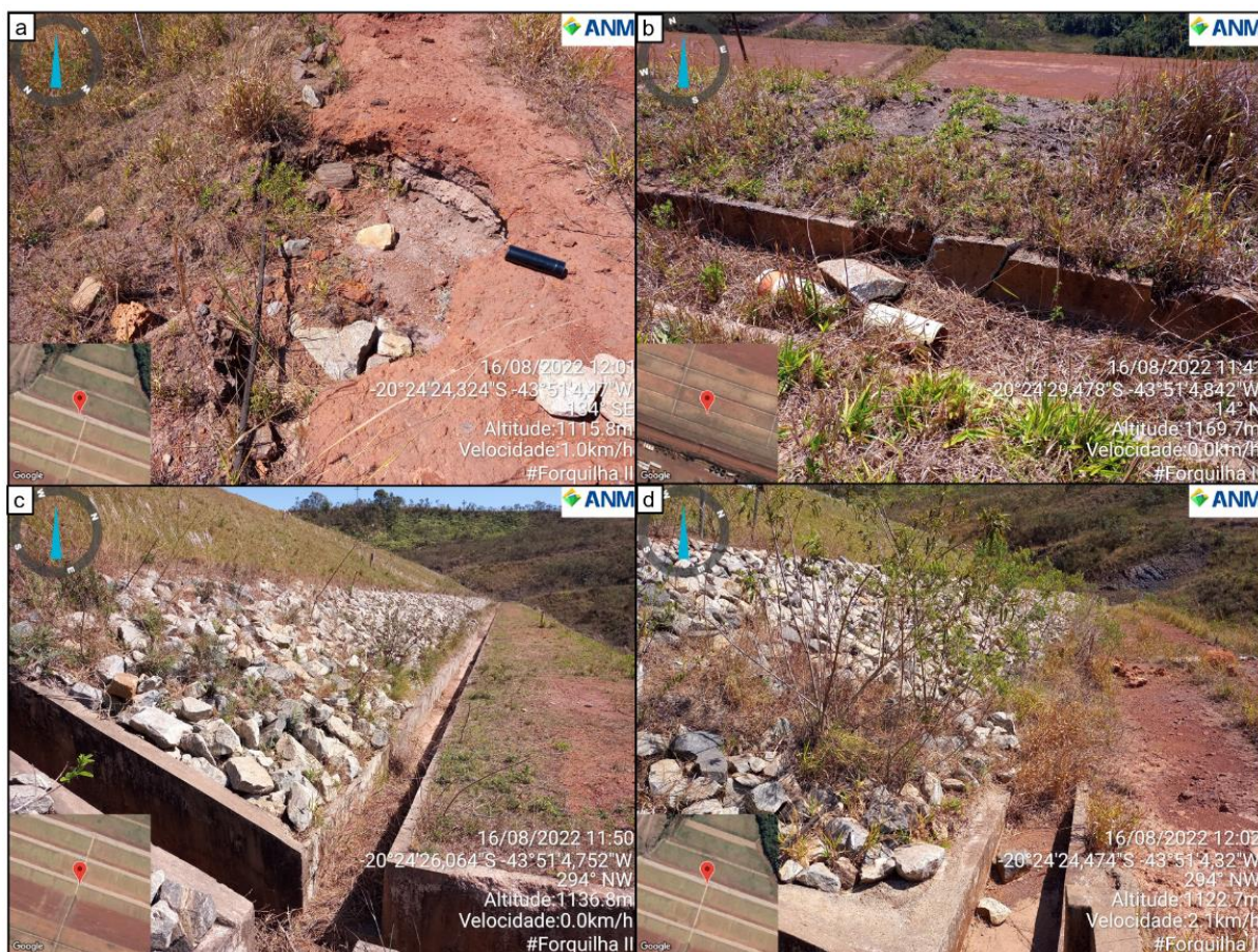
Figura 25. Sinais de erosões próximo a descida de água (a) e canaleta de berm com danos estruturais (b). Saídas de drenagem interna sem fluxo de água (c, d).
