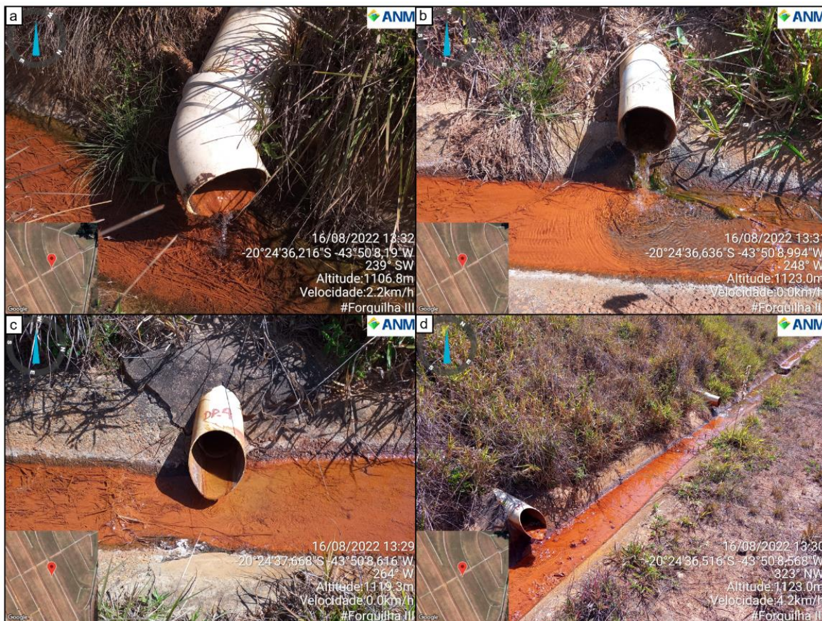
Figura 33. Drenos horizontais com fluxo de água, sem sedimentos aparentes, na terceira berma.
