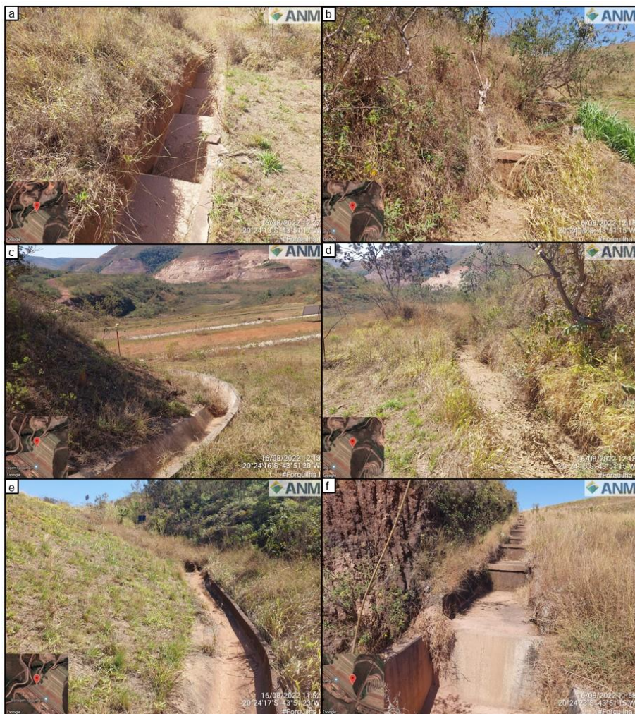
Figura 18. Dispositivos de drenagem – ombreira esquerda (a, c, e) e ombreira direita (b, d, f). Alguns pontos com obstrução na região da ombreira direita.
