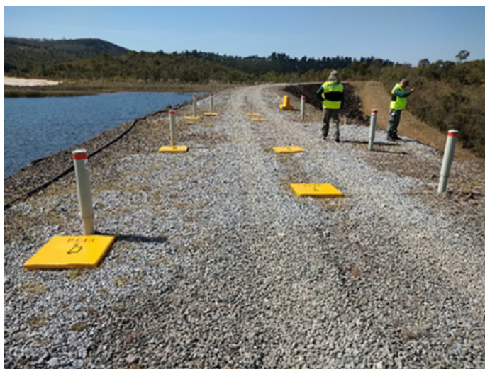
Foto 05: Piezômetros instalados na crista da Barragem de Rejeitos.
