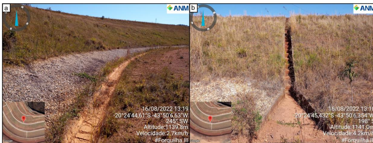
Figura 35. Saída de drenagem interna na segunda berm e escada hidráulica do talude superior em boas condições estruturais.
