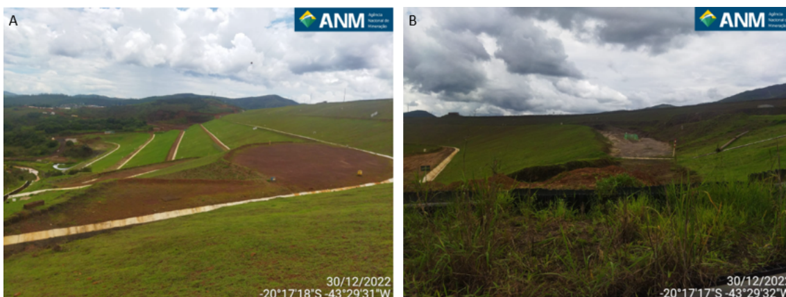
Figura 12 - (A) Imagem do talude de jusante do maciço principal da Barragem Doutor; (B) Erosão presente no contato do talude de jusante com o terreno natural.
