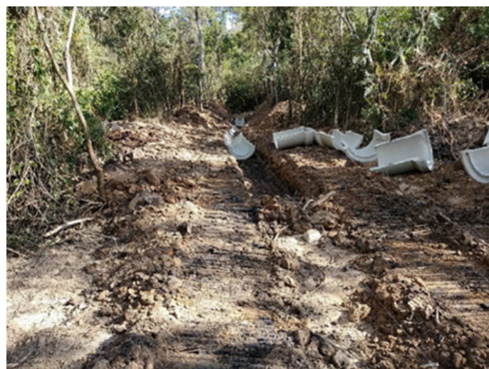
Foto 20: Construção de canal de desvio do efluente tratado na ETE da Barragem D4 (BIA, D3 e D4). O canal desemboca no Córrego do Bota-fora 8.
