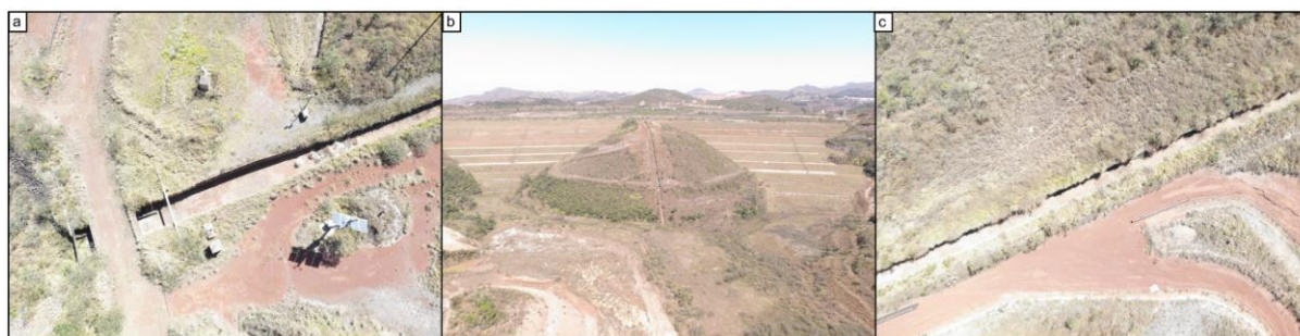
Figura 23. Canal extravasor. (a) vista em planta da região imediatamente a jusante do emboque; (b) vista frontal, com Forquilha II à esquerda, e Forquilha I à direita; (c) trecho adjacente ao acesso da ombreira esquerda.
