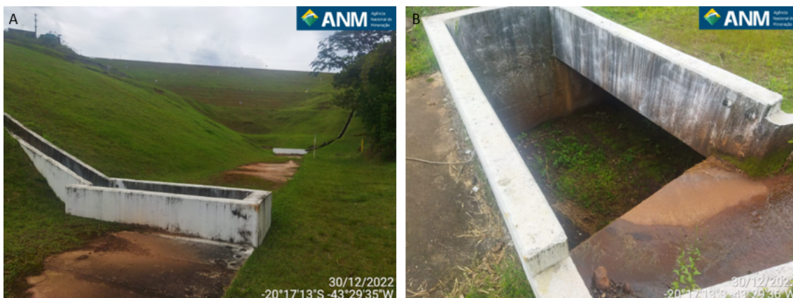
Figura 21 - (A) Túnel do antigo canal extravasor presente na estrutura; (B) Ausência de passagem de água, onde a estrutura se apresenta seca.
