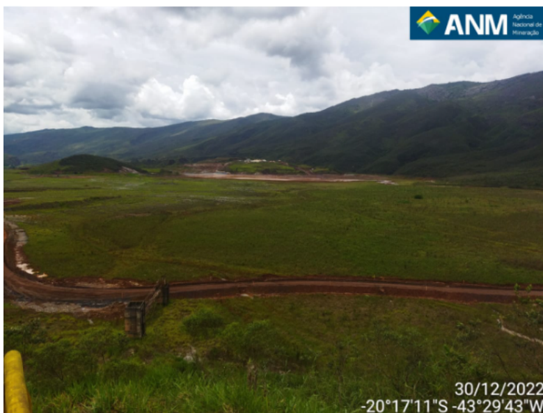
Figura 13 - Reservatório da Barragem Doutor. A lâmina de água contida no reservatório de concentra próxima ao sistema de vertimento da estrutura. Ao fundo da imagem também é possível visualizar o limite da bacia hidrográfica do córrego água suja, região íngreme com alta altitude e baixo tempo de concentração.
