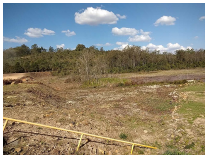
Foto 18: Vista da crista do Dique D3 e da porção completamente assoreada da Barragem D4.
