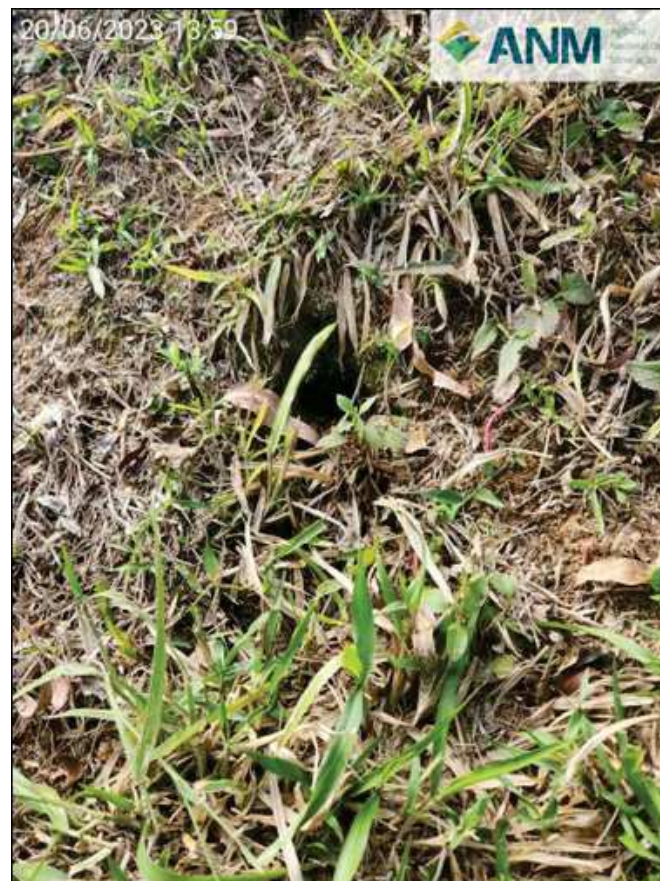
Figura 3.4 – Buracos de animais no talude de jusante
