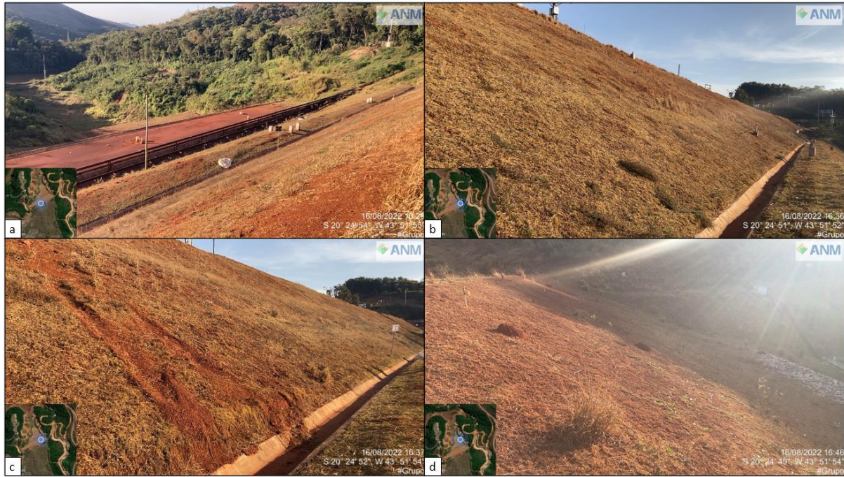
Figura 10- Talude de jusante (a) Vista do talude de jusante (b) Detalhe do talude e canaletas de berma (c) Detalhe de movimentação superficial de material (d) Presença de formigueiros nos taludes.
