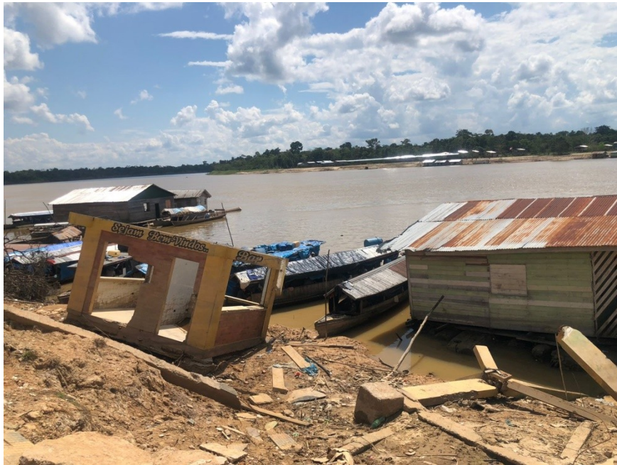
Antigo Prédio da Funai em Atalaia do Norte, próximo a desabar – 01/07/2022
