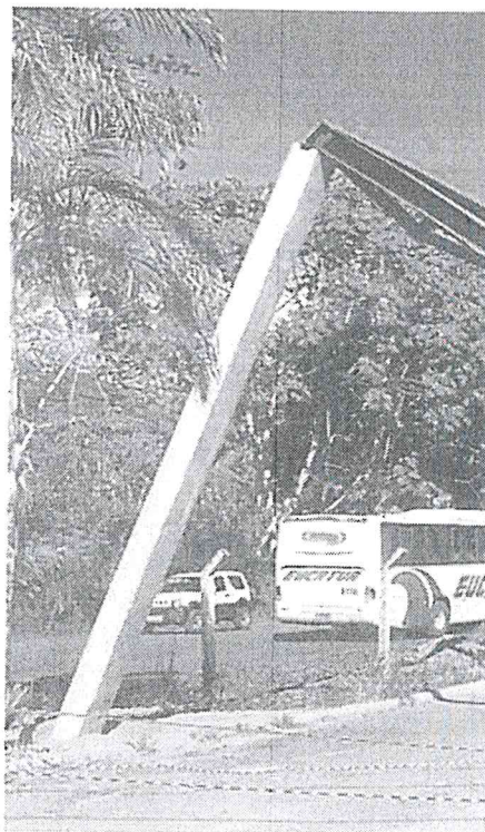
Figura 10: Pilar P1 com ruptura na base e "arrancamento" de fundação,
