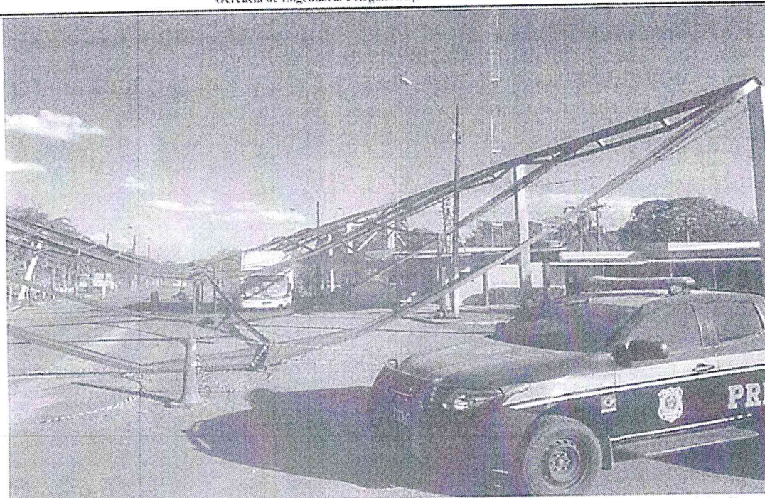
Figura 12: Vista lateral direita, onde os pilares sofreram menos deformações. Obs.: Esta lateral possui 6 pilares.
