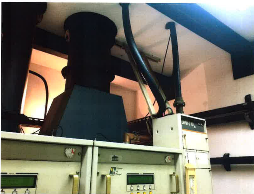
Foto 5 – Saída de ar quente do Transmissor.
