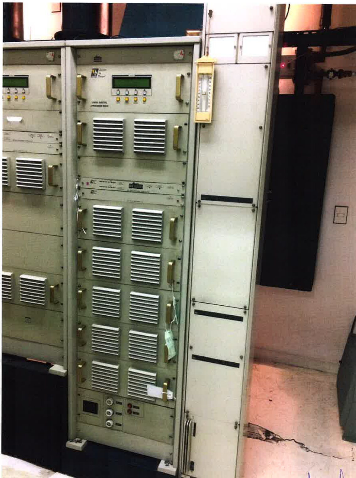
Foto 1 – vista frontal do Transmissor
