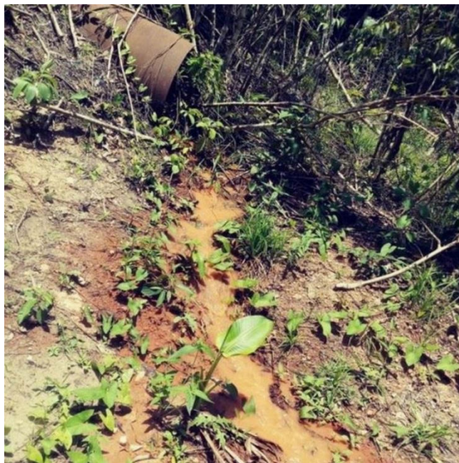
Figura 1 – “Tubo Clandestino” verificado em vistoria.
