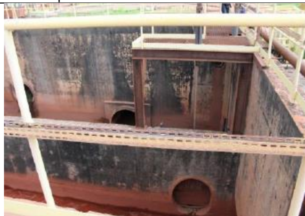
Figura 22 – Detalhe da comporta existente entre os dois compartimentos da caixa, que pode permitir a mistura dos efluentes.
