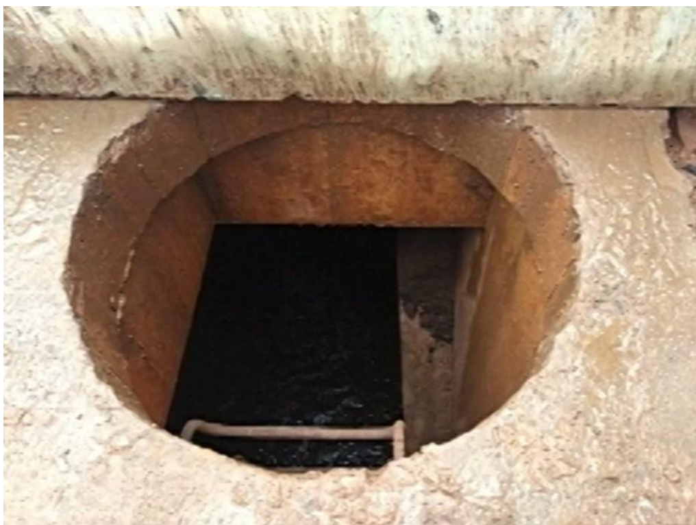
Figura 2 – Terceiro ponto clandestino de lançamento de rejeitos da Hydro Alunorte.
