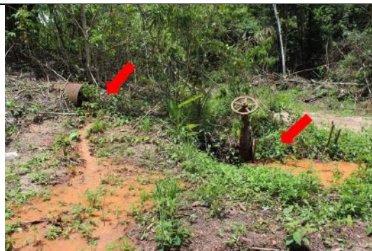
Figura 19 – Ponto de lançamento da tubulação irregular
