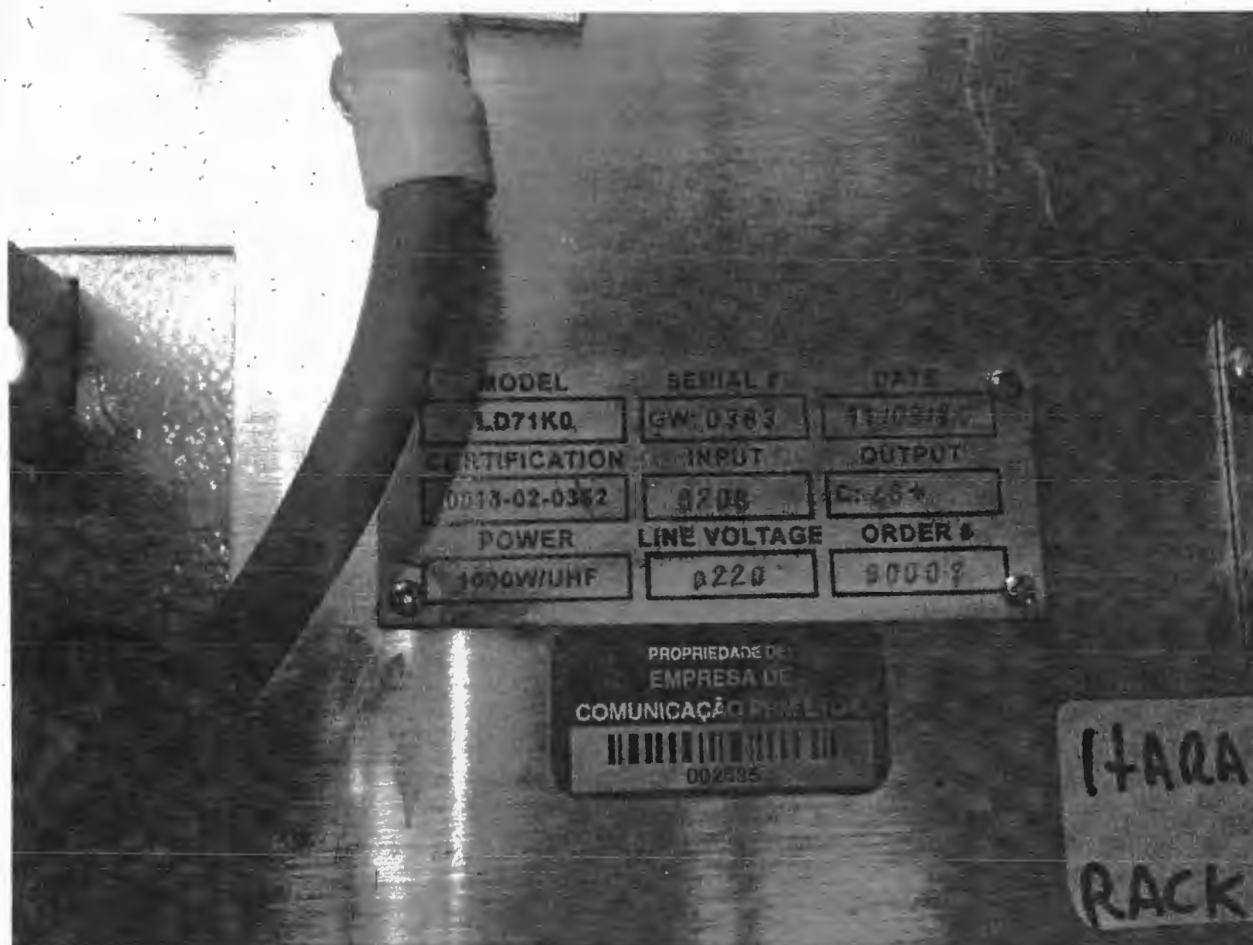
Foto 4 – Placa de identificação do equipamento
