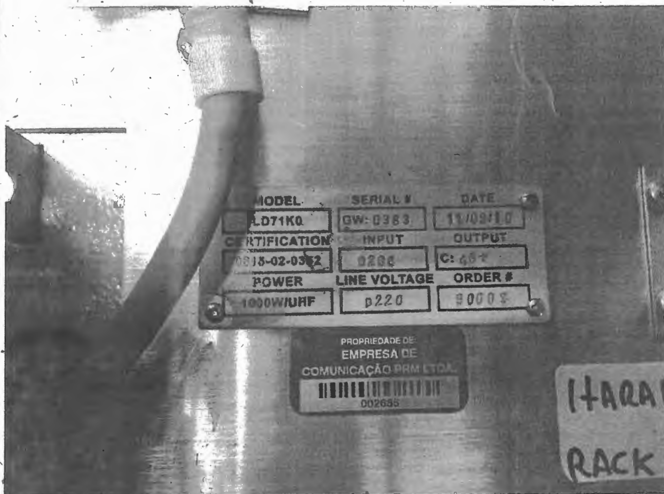
Foto 4 – Placa de identificação do equipamento
