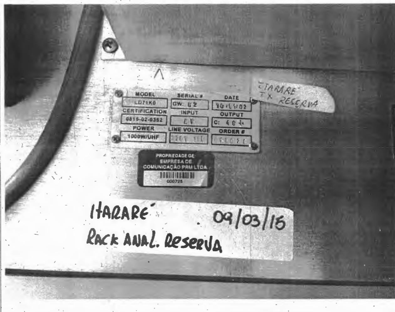
Foto 4 – Placa de identificação do equipamento
