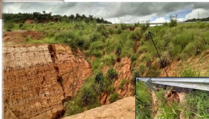
Erosão da plataforma da rodovia (Localização 4.3108472°S, 46.5777583°W)
