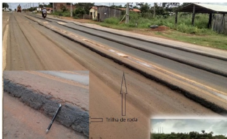
Afundamento em trilha de roda de alta severidade (Localização 4.3125567°S, 46.2914619°W)
