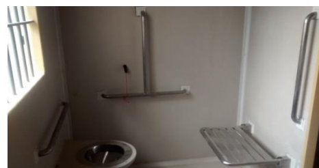
Banheiro adaptado na cela
