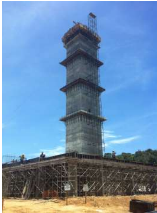
Obras da Torre de Controle – Aeroporto Salvador (25% de execução na data da visita da Subcomissão)
