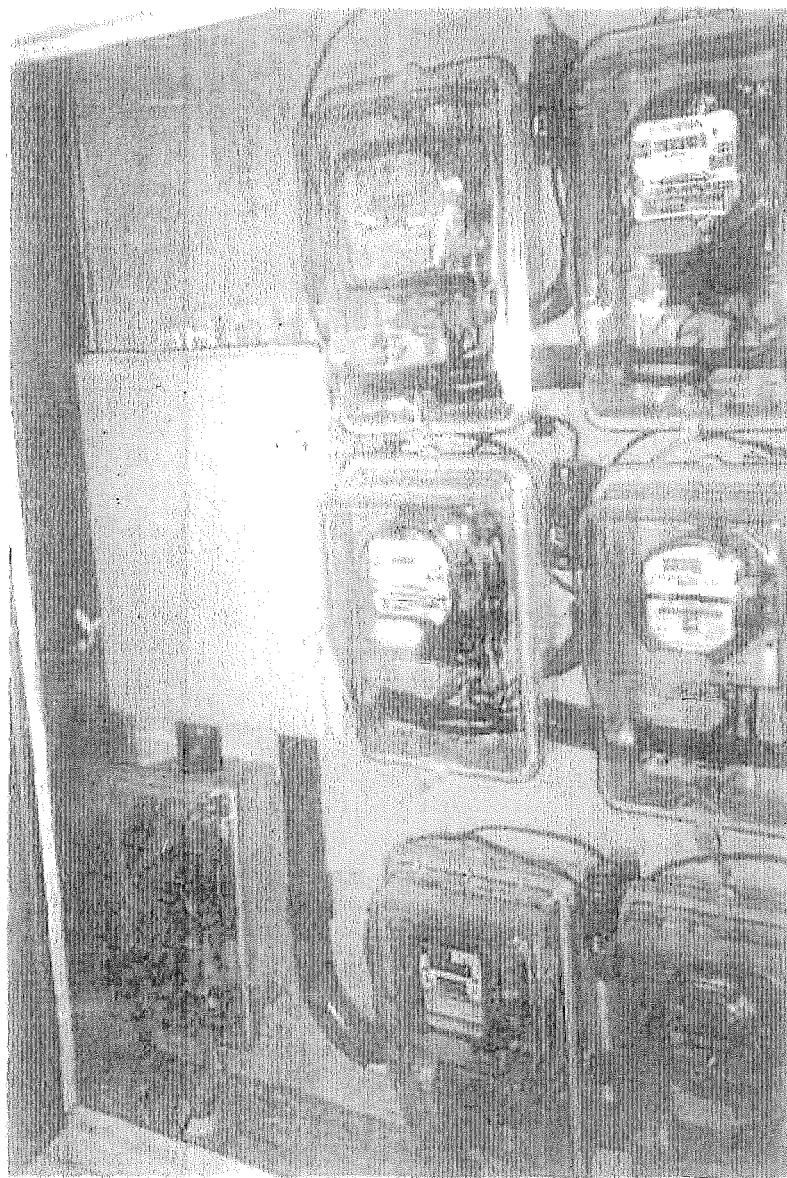
Fig. 8 – Blindagem de Barramentos de Uso Coletivo
