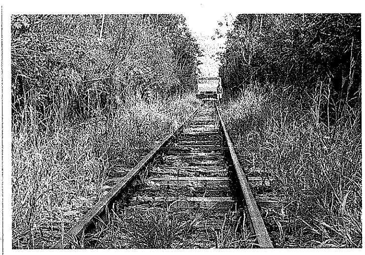
Trecho operacional coberto pela vegetação – manutenção deficiente
