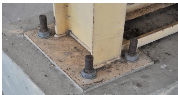
Figura 3 – Sinais de má conservação em estruturas da estação elevatória
