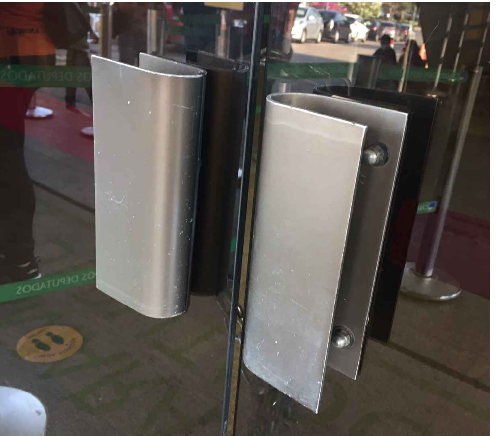
Anexo IV - Esquadrias Foto 03 - Puxador padrão existente
