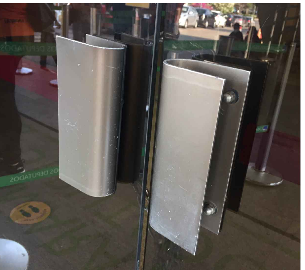
Anexo IV - Esquadrias Foto 03 - Puxador padrão existente
