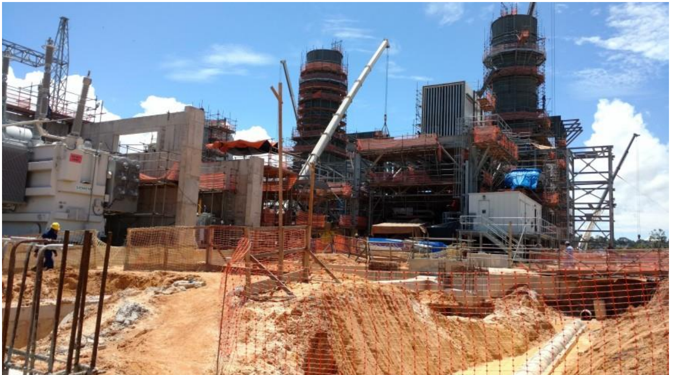
Chaminés de by-pass
