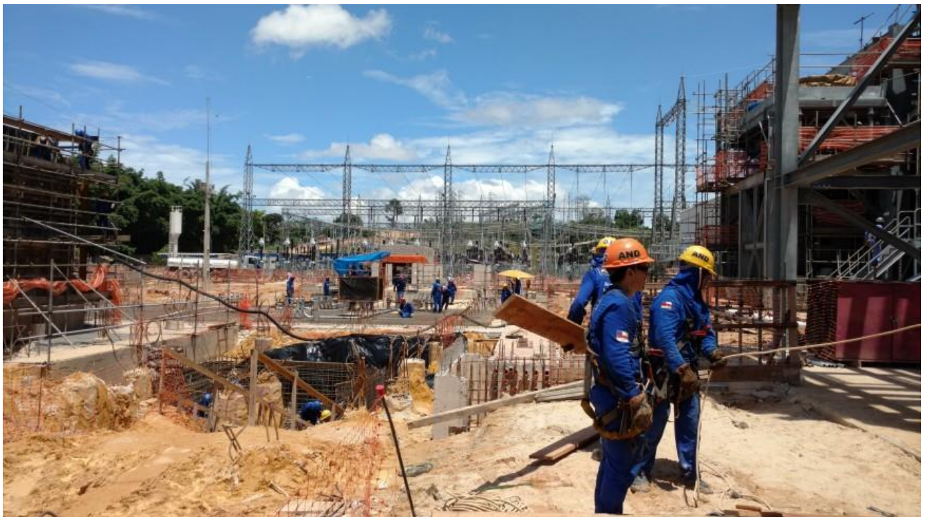
Subestação ao fundo
